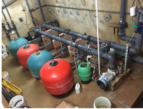
Figura 9. Instal·lació filtratge piscina
