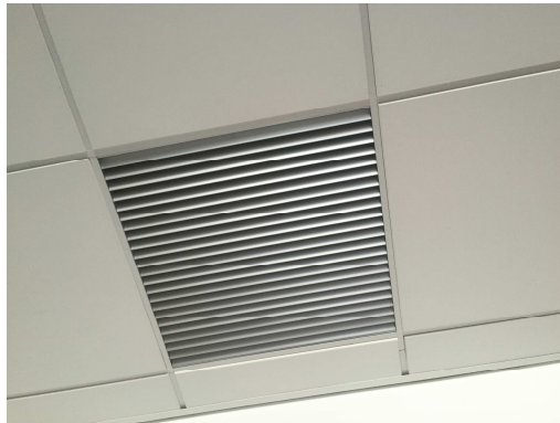
Figura 3. Reixes de ventilació i climatització
