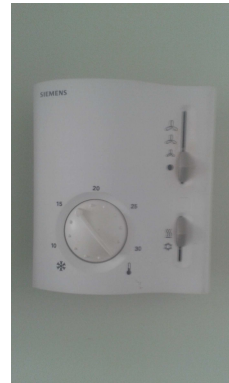
Figura 4. Termòstats de climatització
