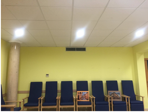
Figura 3. Reixes de ventilació i climatització
