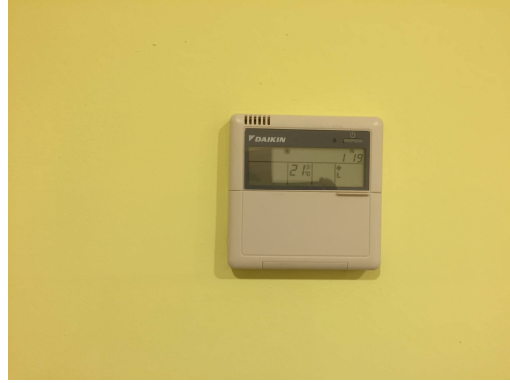
Figura 4. Termòstats de climatització
