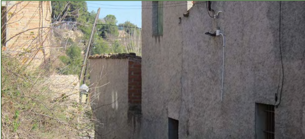
Fotografies 5: Pendents pronunciats adjacents a la Casa Ermitans (M49). Font: Equip redactor 2023.
