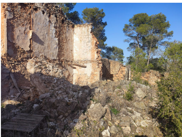
7. Façana nord en ruïnes
