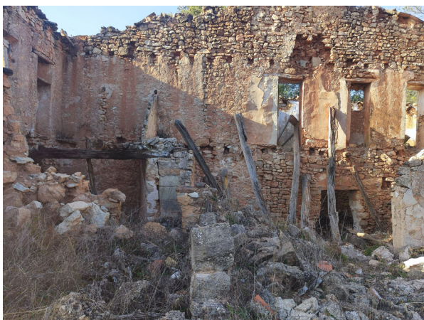
3. Façana nord en ruïnes
