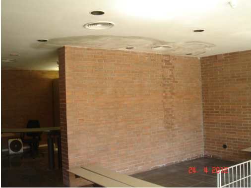
FOTO 1. Vista del fals sostre vestíbul després de pluges.
