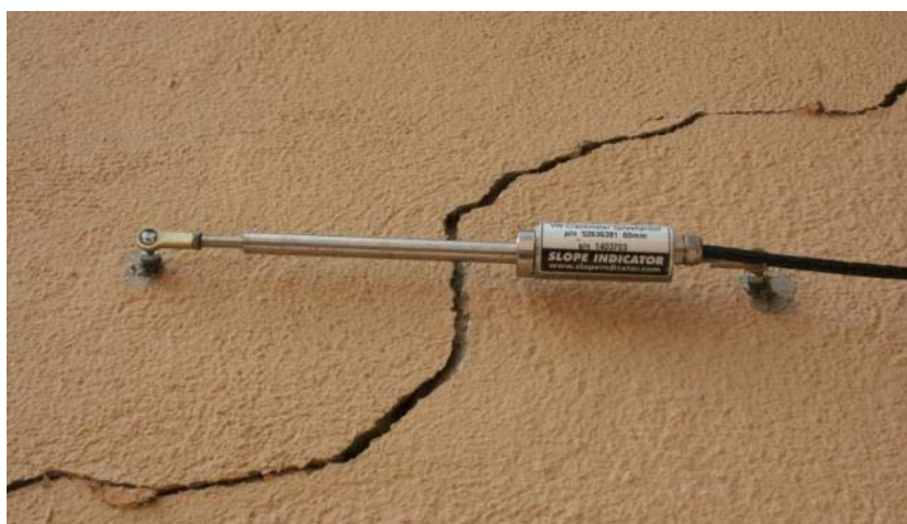
Fotografia 22. Exemple de fissurímetre: FCV-4 instal·lat al carrer Font Alzinella, X
