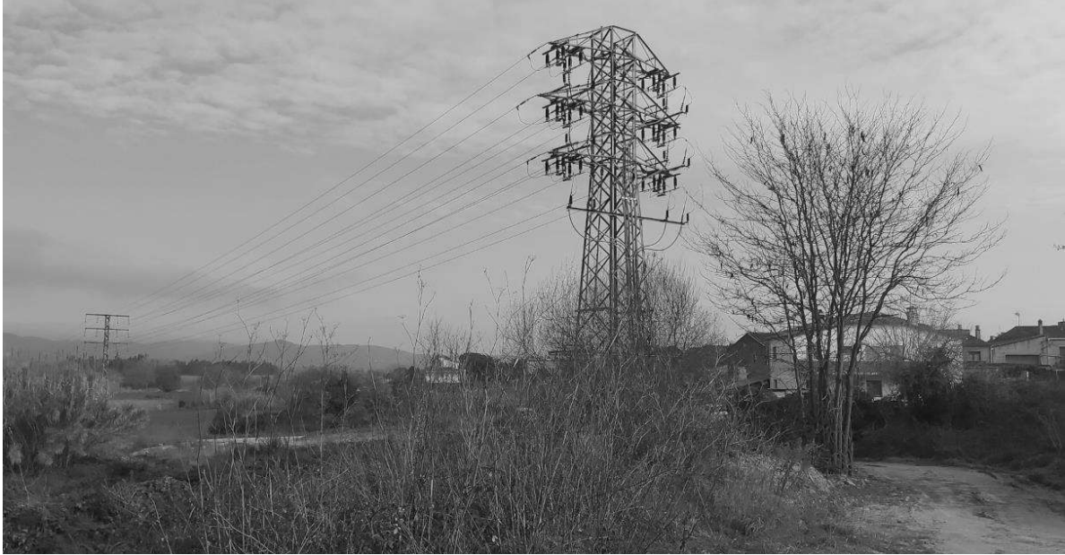
Figura 25. Imatge Línia de Mitja Tensió – Zona 1
