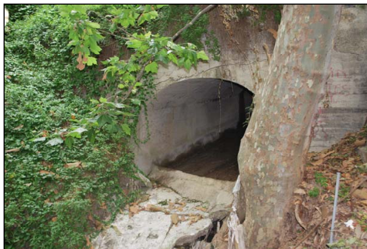
Figura 10. Imatge de l'abocament al torrent de Cal Manel.
