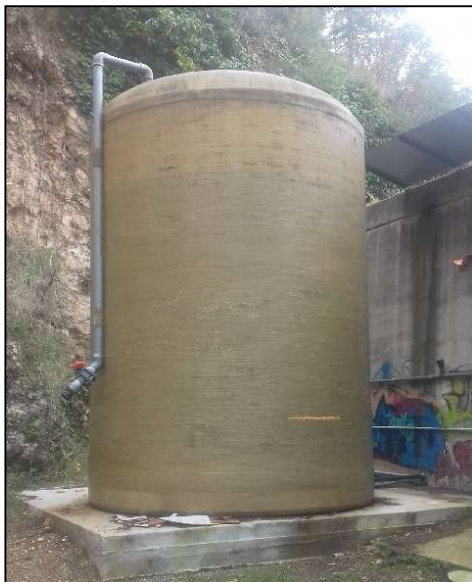
Dipòsit de Clorur Sòdic diluït existent en l'àmbit de la planta de tractament i detall de la boca de càrrega.
