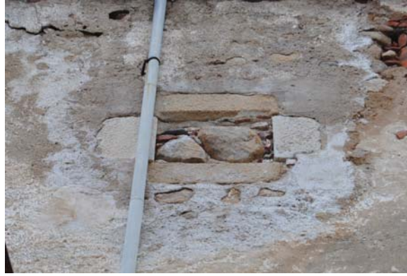
Obertura quadrangular tapiada, ubicada a l'angle superior dret de l'habitatge número 13
