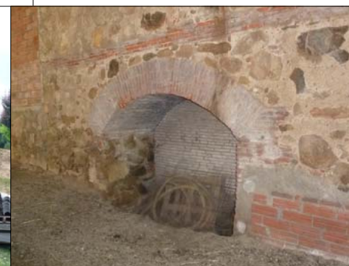
Interior cobert (punt encesa forn)
