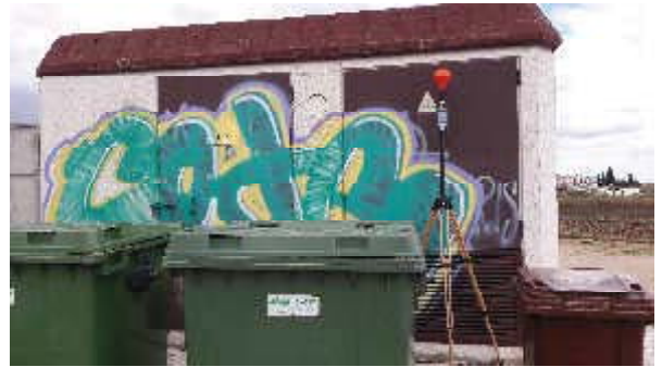
Punt de mesura 11 (LE): Transformador Fecsa 63777 Cr. 26
