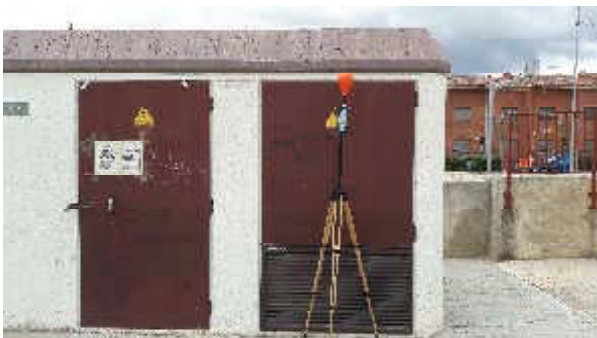
Punt de mesura 8 (LE): Transformador Fecsa 33207, pta dreta
