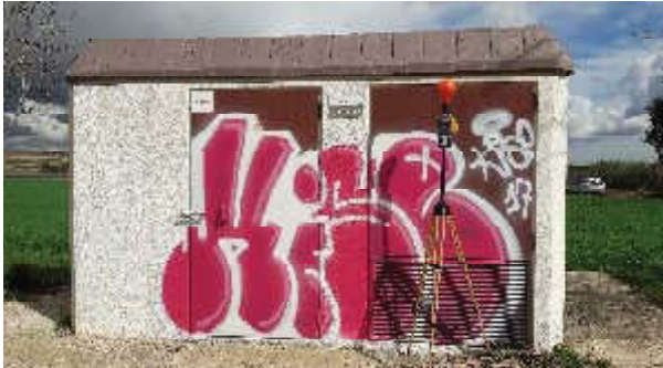
Punt de mesura 10(LE) : Transformador Fecsa 33208, camí de la Granada
