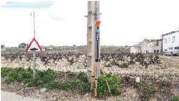
Punt de mesura 4 (LE) : Línia mitja tensió, carrer cinc
