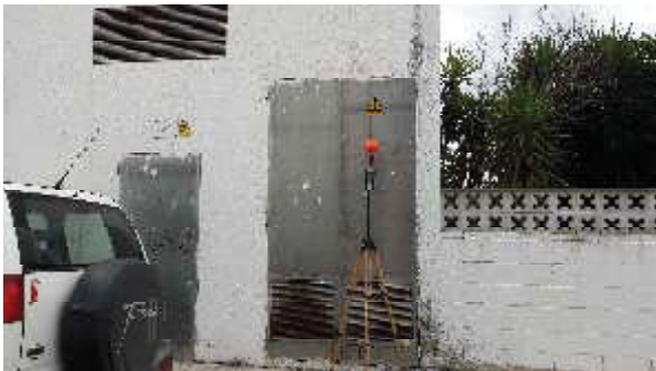
Punt de mesura 6 (LE): Transformador Endesa BD357, Cr. 20
