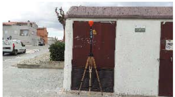
Punt de mesura 7 (LE) : Transformador Fecsa 33207, Cr. 27
