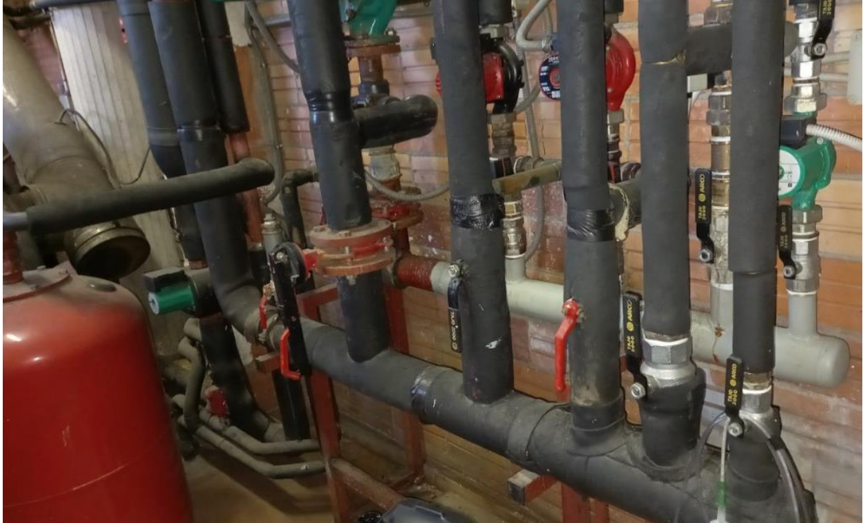
Figura 23: Col·lector d'impulsió/retorn estat actual.
