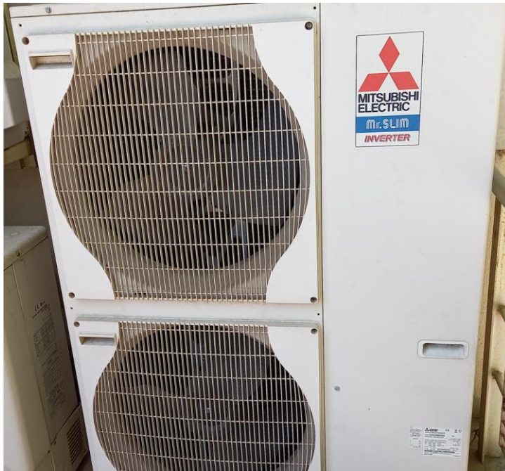
Figura 3: Unitat exterior MITSUBISHI P200YHA3.
