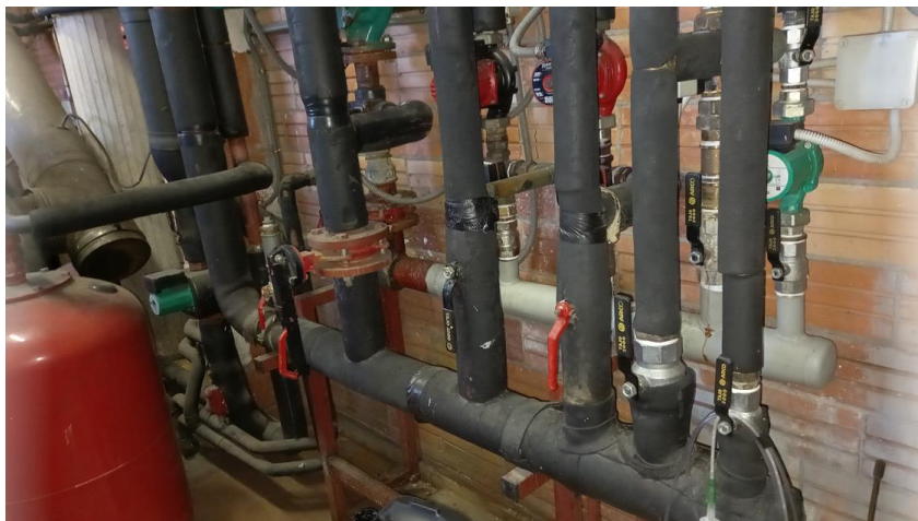
Figura 9: Col·lector existent de calefacció.
