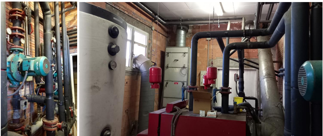
Figura 8: Elements de la instal·lació existent dins la sala de calderes.
