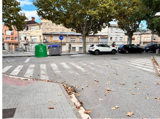
Imatge 6. Pas de vianants amb pintura en mal estat
