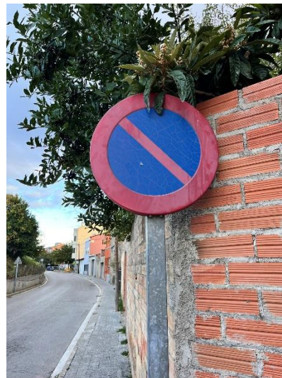
Imatge 4. Senyal vertical en mal estat
