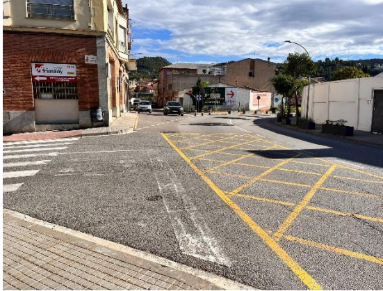
Imatge 5. Via Augusta amb Avinguda del Secretari Canal, Stop en mal estat
