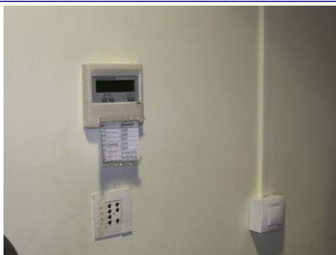
Termòstat sala teatre, ubicat a la cabina de control
