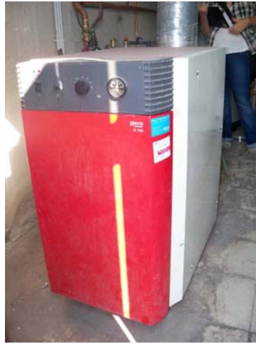
Caldera Roca de gas natural ACS resta vestuaris
