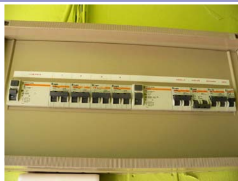
Quadre elèctric general gimnàs
