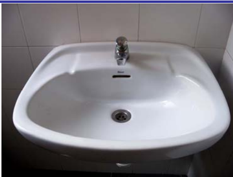
Piques lavabos Jutjat, primera planta
