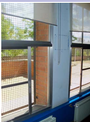
Cortines tancaments aula edifici educació infantil
