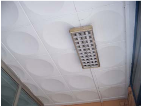
Fluorescents 36W accés principal edifici
