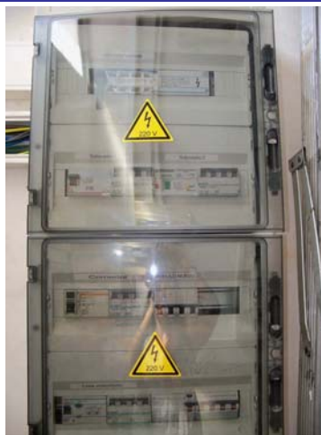
Quadre elèctric general edifici
