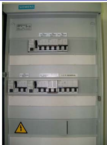
Subquadre elèctric sala 2, primera planta
