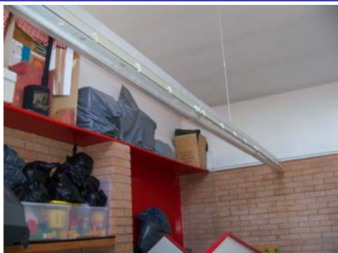
Fluorescents 58W aula edifici educació infantil
