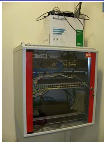
Rack general edifici aula S5, primera planta
