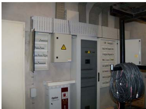
Quadres elèctrics edifici
