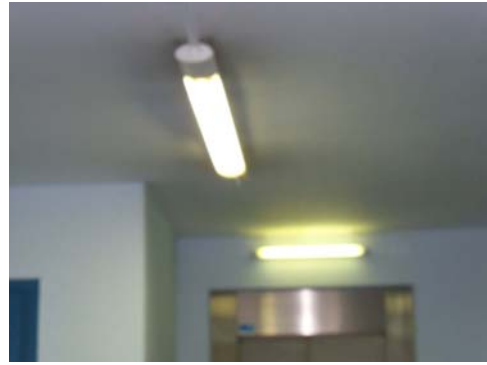
Fluorescent 36W vestíbul entrada principal edifici
