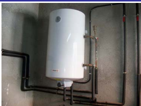
Acumulador ACS, sala caldera
