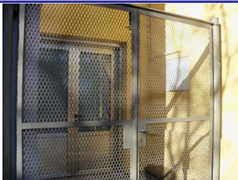
Nova ubicació comptador d'electricitat
