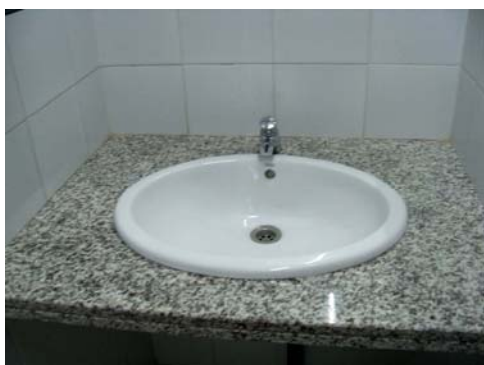
Aixeta temporitzada pica lavabos públic
