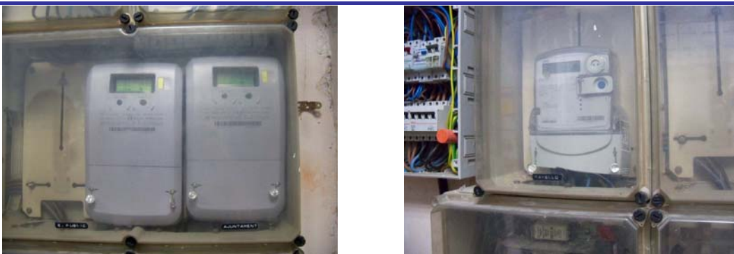
Comptadors d'electricitat actuals
