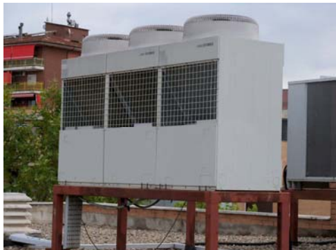
Bomba de calor de la climatització de les aules i oficines
