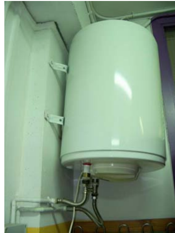
Escalfador elèctric Edesa laboratori segona planta
