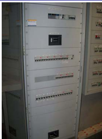
Quadre elèctric general
