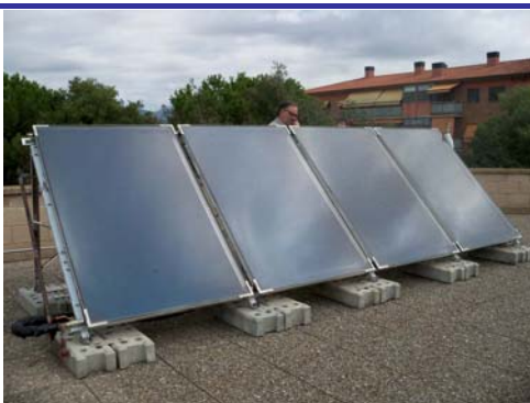
Instal·lació solar tèrmica
