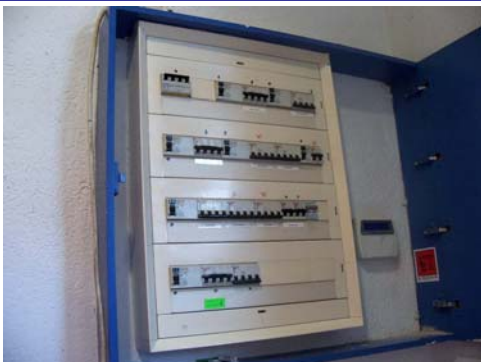
Quadre elèctric general
