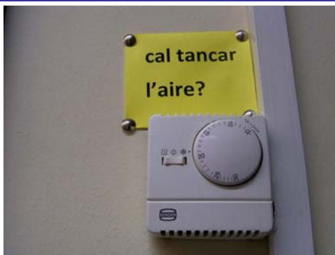
Termòstat climatització oficina català, planta baixa
