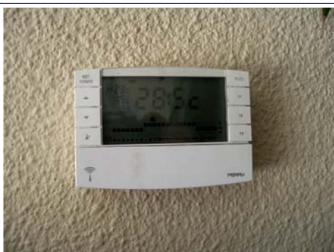
Termòstat edifici direcció ubicat al vestíbul edifici direcció
