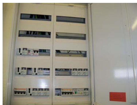
Quadre elèctric laboratori primera planta edifici educació primària
