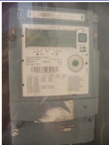
Comptador electricitat Landis+Gyr
