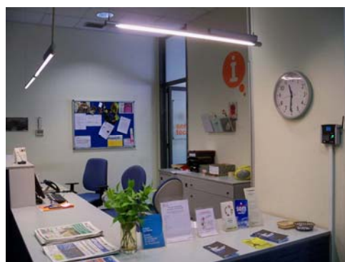
Fluorescents T5 taulell entrada oficines i aules, planta baixa
