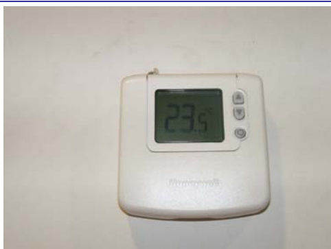
Termòstat vestuari homes Policia Local, primera planta
