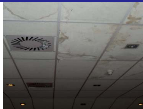
Taques d'humitat d'antigues filtracions d'aigua al sostre de la zona de butaques
