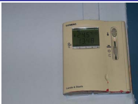
Termòstat calefacció, planta baixa
