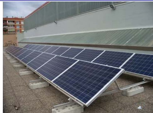
Instal·lació solar fotovoltaica
