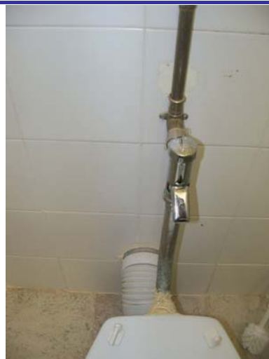
WC amb descàrrega amb regulació de cabal, edifici d'educació primària
