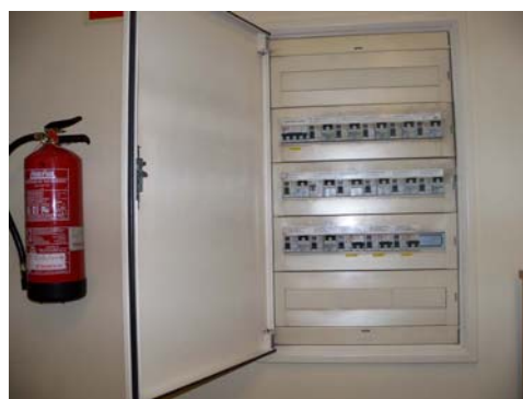
Quadre elèctric primera planta
