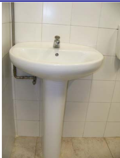
Aixeta temporitzada, edifici d'educació primària
