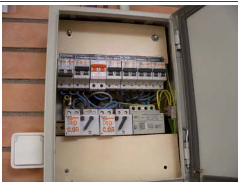
Quadre elèctric general edifici educació infantil
