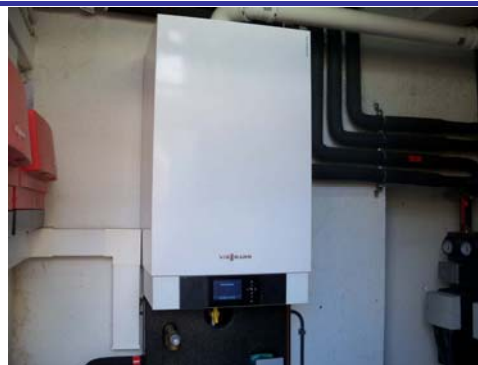
Caldera nova de gas natural
