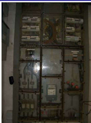
Quadre elèctric general edifici educació primària
