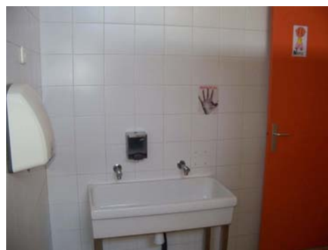
Aixetes pica lavabos edifici principal
