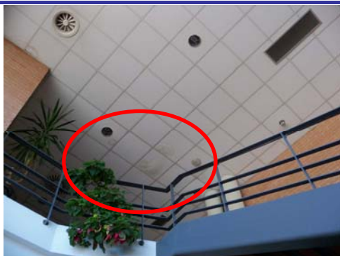
Taques d'humitat d'antigues filtracions d'aigua al sostre de la primera planta
