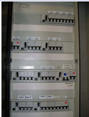
Subquadre elèctric camerinos
