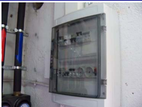
Quadre elèctric sala de calderes
