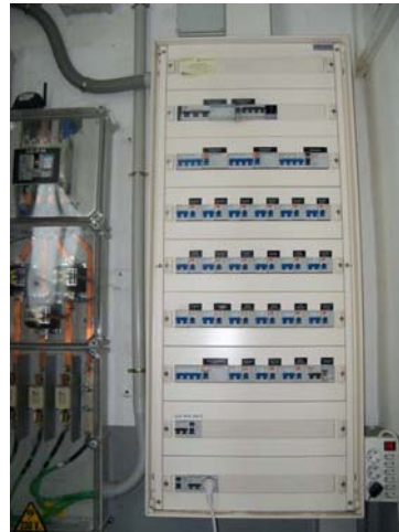
Quadre elèctric general edifici, planta baixa
