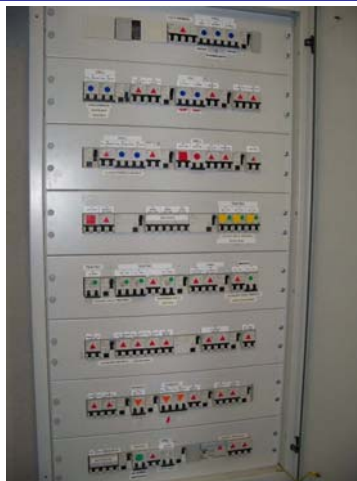
Subquadre elèctric sala teatre, hall i Sala Arimany
