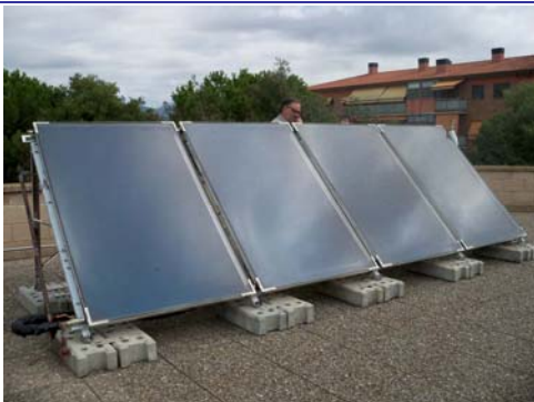
Instal·lació solar tèrmica
