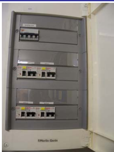
Quadre elèctric servidor primera planta edifici educació primària
