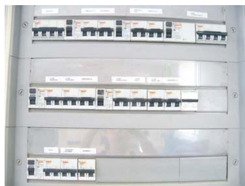
Quadre elèctric general edifici – planta baixa
