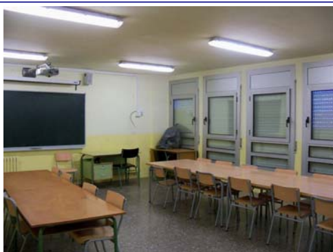
Fluorescents 36W aula primera planta edifici educació primària
