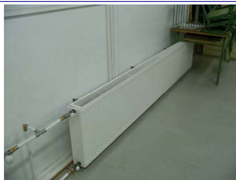
Radiador ferro laboratori segona planta
