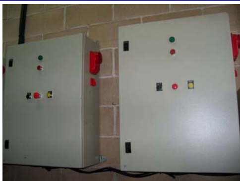
Quadre elèctric controls grades pista
