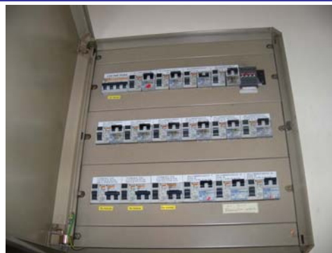
Quadre elèctric general
