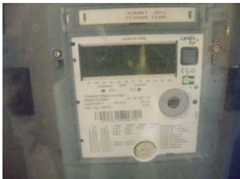
Comptador electricitat Landis+Gyr
