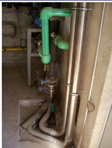
Ramals nous de la calefacció que van a l'edifici d'educació infantil
