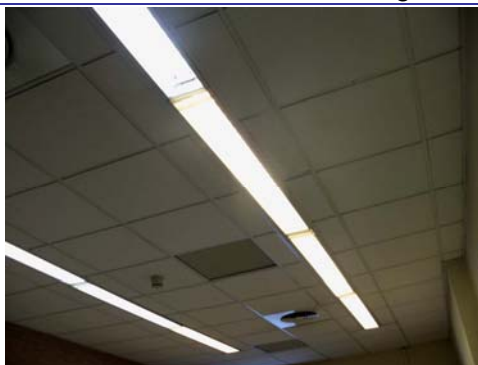
Fluorescents amb reactàncies electròniques
