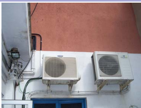
Aparells aire condicionat pati interior
