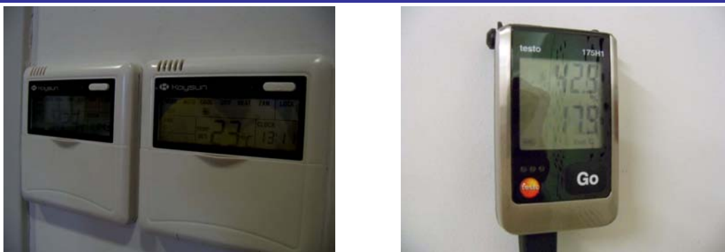
Termòstats i control temperatura i humitat sala documents Arxiu – primera planta
