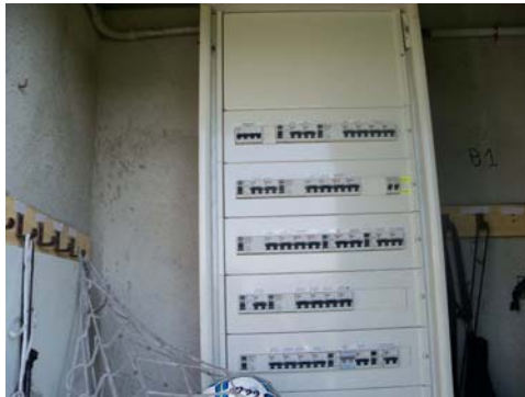
Quadre elèctric part antiga vestuaris
