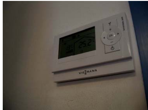
Termòstat despatx secretari, primera planta
