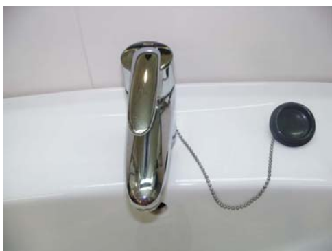
Pica amb aixeta amb monocomandament vestuari dones Policia Local, primera planta
