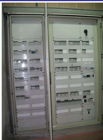
Quadre elèctric general
