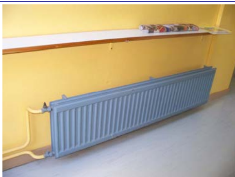
Radiador ferro passadís primera planta
