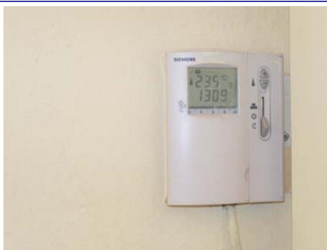
Termòstat calefacció, segona planta
