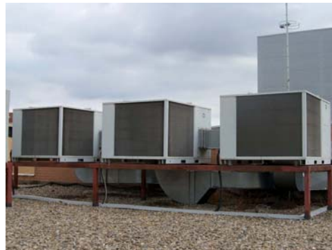
Bombes de calor de la climatització del teatre i del hall
