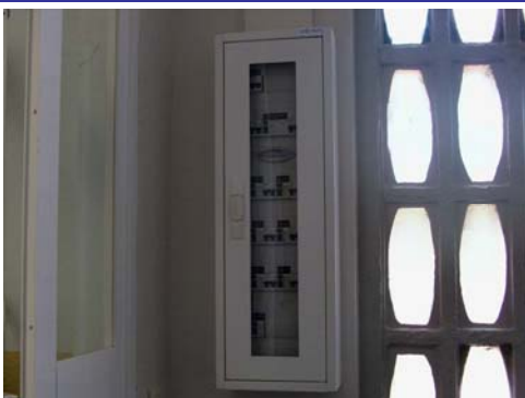
Quadre elèctric Jutjat, primera planta
