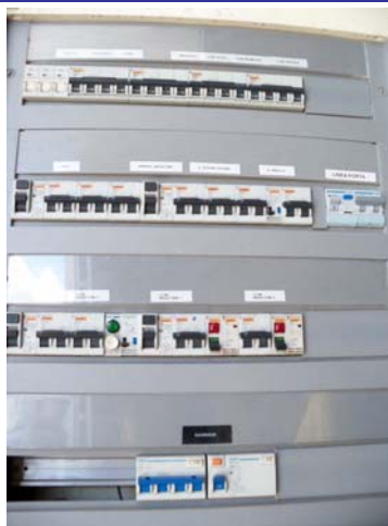
Quadre elèctric nau brigada municipal
