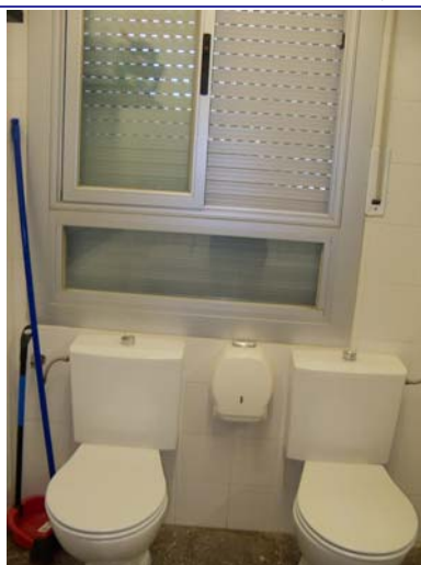
WC amb botó de descàrrega, edifici d'educació primària
