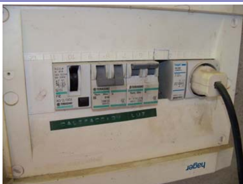
Quadre elèctric sala calderes, edifici direcció
