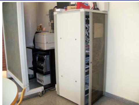
Rack general despatx direcció, primera planta
