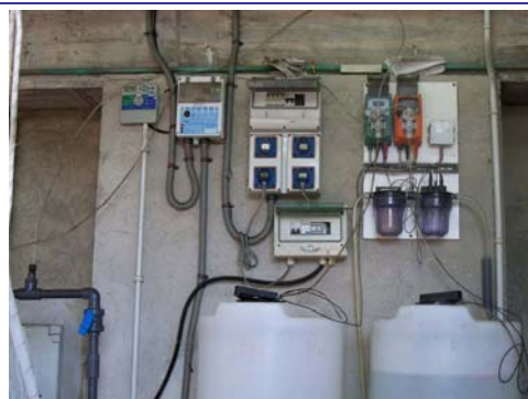
Quadre elèctric sistema tractament pou
