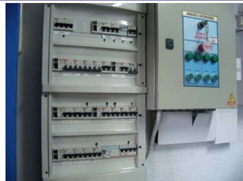
Subquadre control vestuaris i pista
