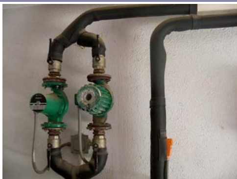
Bombes circuit de calefacció
