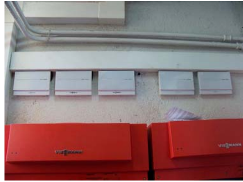
Receptors termòstats (sala calderes)
