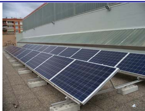
Instal·lació solar fotovoltaica
