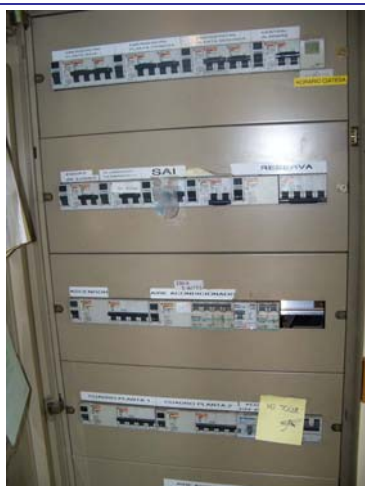
Quadre elèctric general amb control dels quadres de la primera i la segona planta
