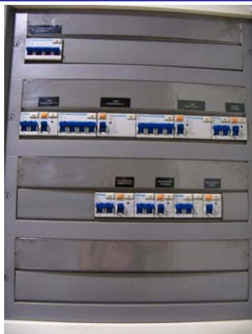
Quadre elèctric Arxiu – primera planta
