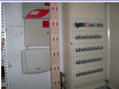
Quadre elèctric oficines
