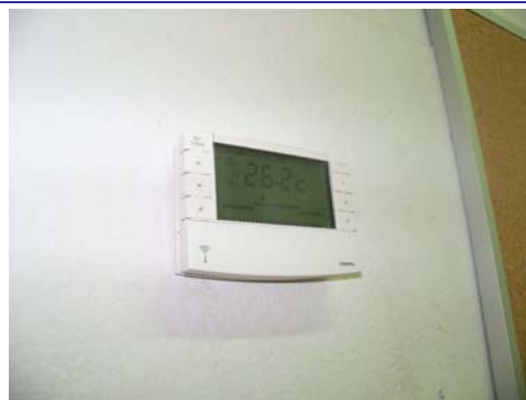
Termòstat passadís primera planta
