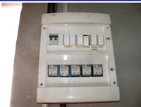
Quadre elèctric sala caldera
