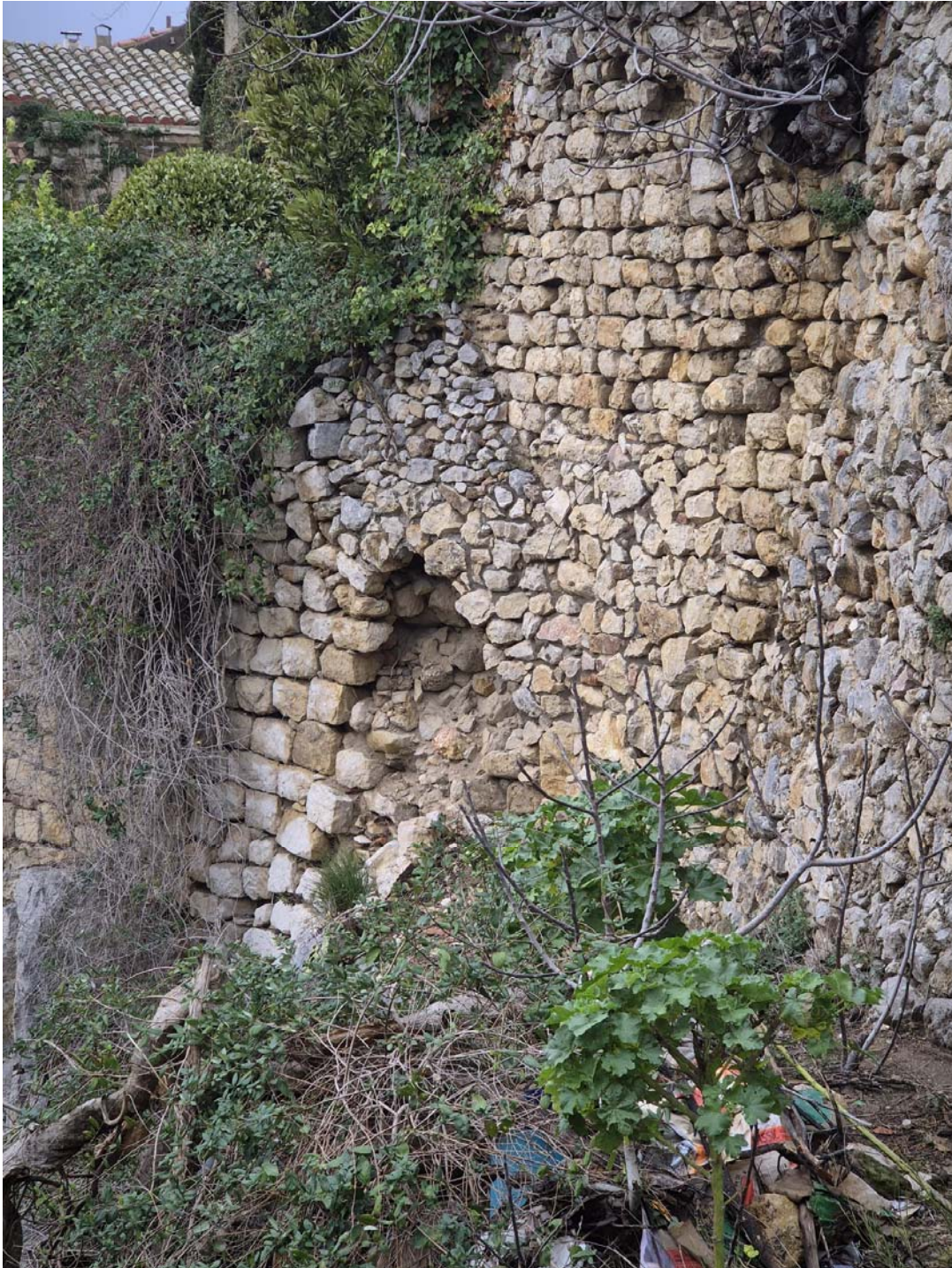
Zona deteriorada; Façana sud – muralla
