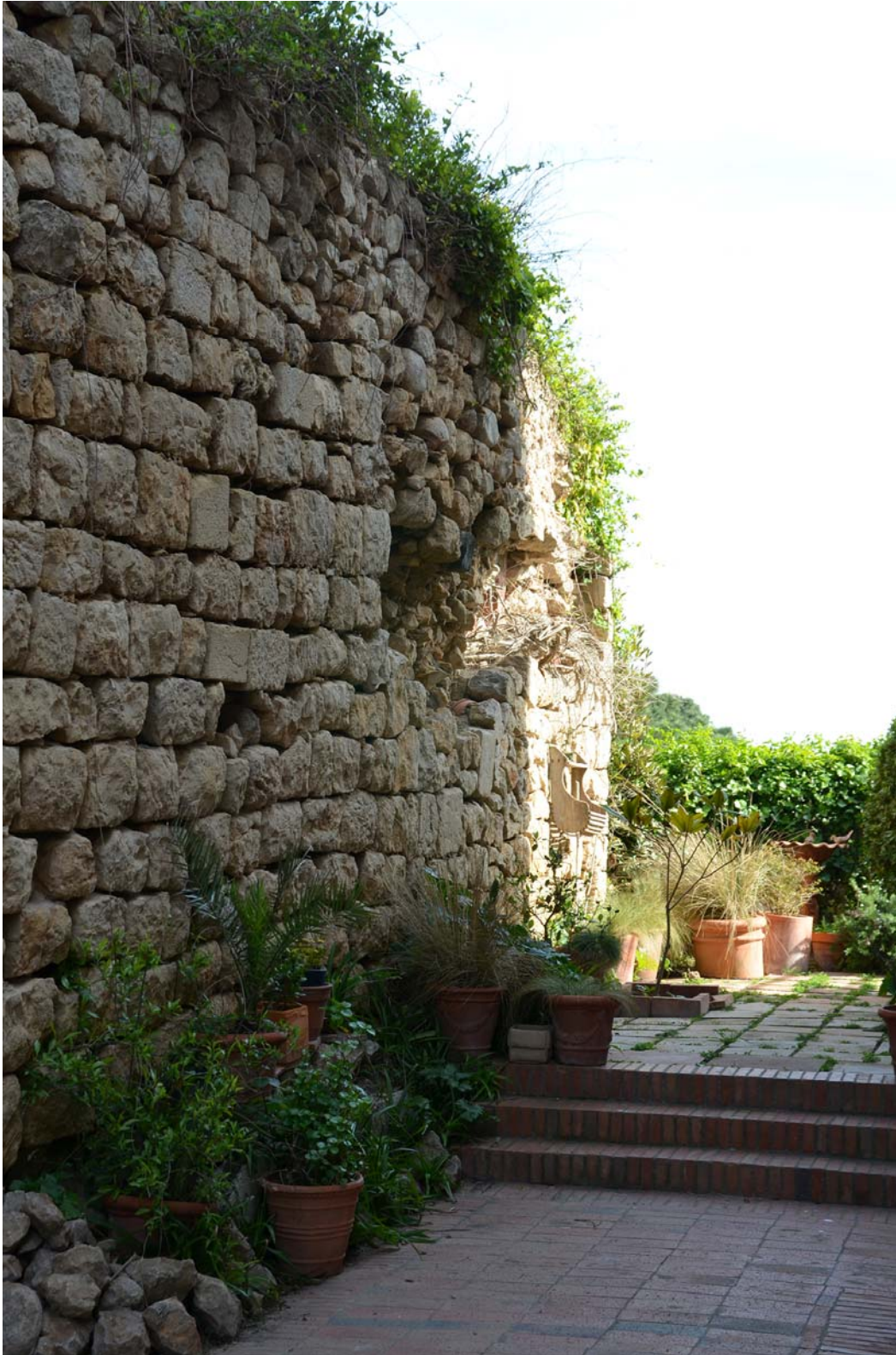
Mur deteriorat i desplomat. Façana oest Castell Carolingi – jardí privat veí.
