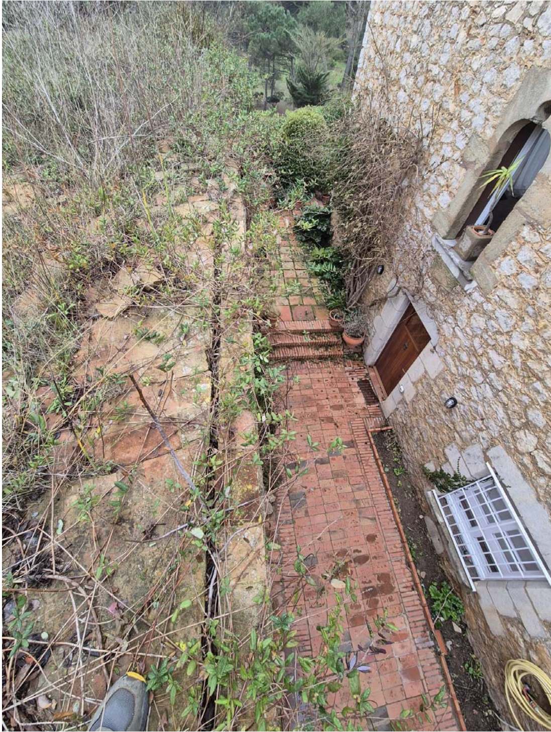
Vegetació/trepadores a retirar. Coronament muralla lateral oest.
