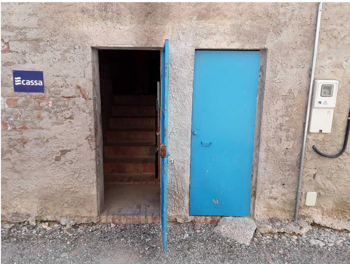
Il·lustració 15: Entrada a l'edificació amb coberta de fibrociment, on es troben els dipòsits A i B.
