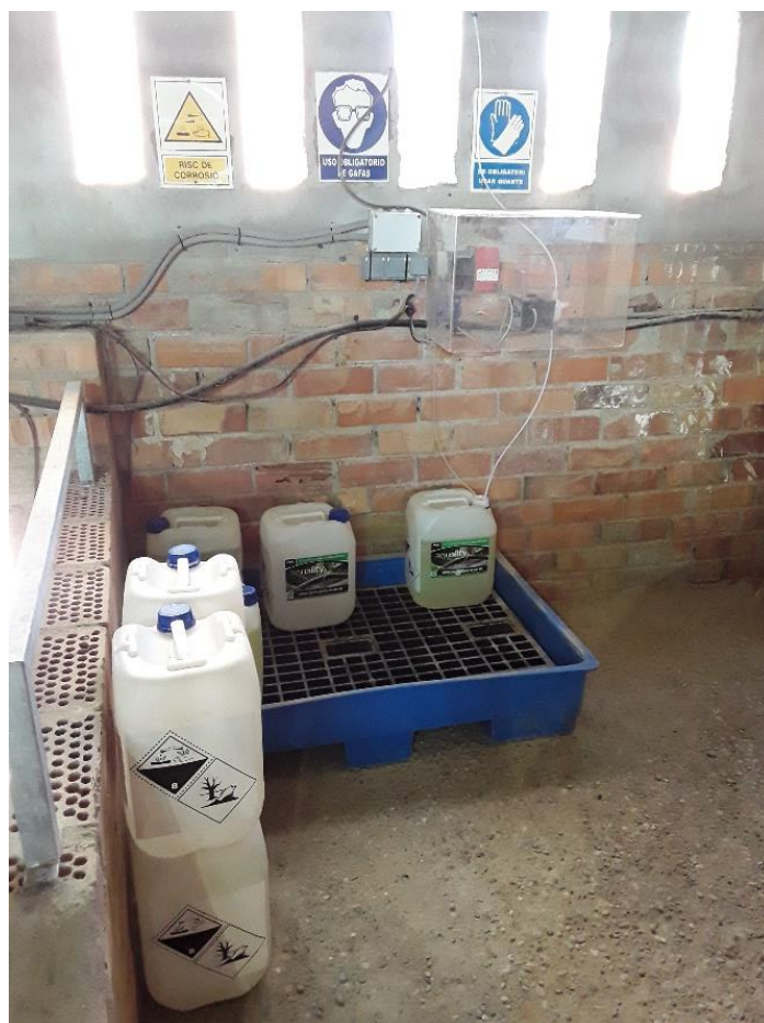
Il·lustració 9: Injector d'hipoclorit sòdic del 15%.
