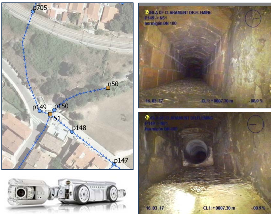
Figura 11: Equip de CCTV utilitzat per investigar trams concrets de la xarxa de clavegueram municipal i exemple concret d'una inspecció, corresponent al node n51 de l'inventari, en que s'enregistra l'entronc de varis conductes de secció transversal heterogènia. Font: NEIDA, S.L.
