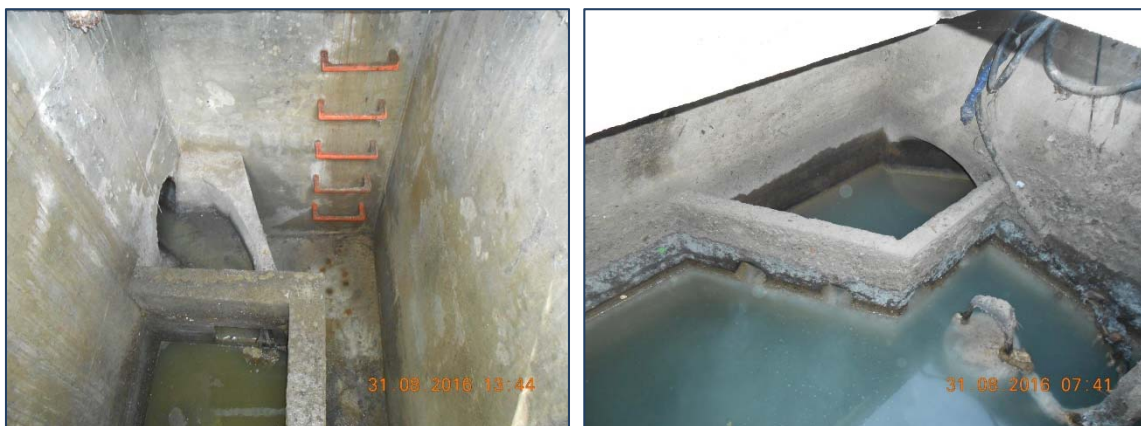
Figura 13: Alguns punts singulars de la xarxa de clavegueram: (esquerra) sobreexidor i connexió a la xarxa de sanejament en alta, al sector “El Xaró” (pou p366 de l’inventari); (dreta) càmera de bombament al sector “Plans d’Arau” (pou p355 de l’inventari). Font: pròpia.
