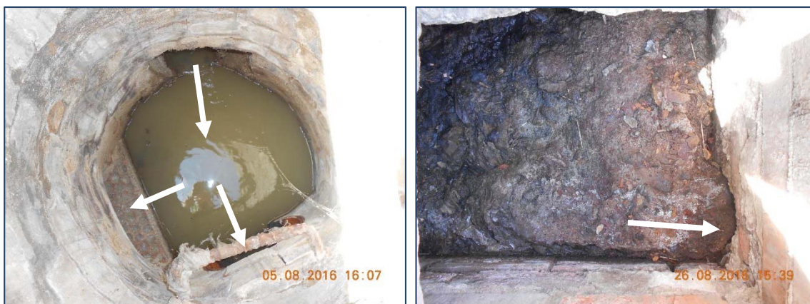
Figura 19: Dos punts problemàtics: (esquerra) pou p138 de l'inventari, a la cruïlla dels carrers Pas Blau i Francesc Salvà, on s'aprecia un muret tapiat que fa de sobreeixidor; (dreta) pou p323 de l'inventari, que dona accés al col·lector en alta i es troba embussat. Font: pròpia.
