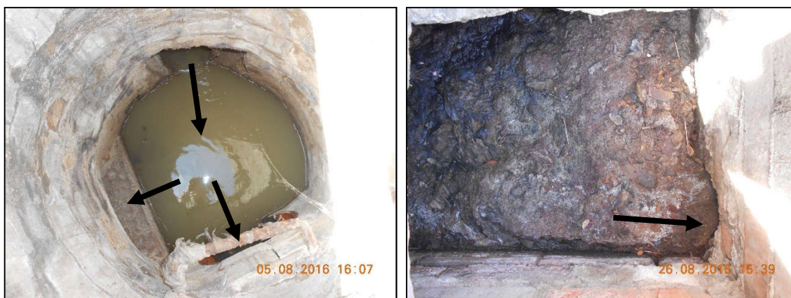
Figura 29: Dos punts problemàtics: (esquerra) pou p138 de l'inventari, a la cruïlla dels carrers Pas Blau i Francesc Salvà, on s'aprecia un muret tapiat que fa de sobreeixidor; (dreta) pou p323 de l'inventari, que dona accés al col·lector en alta i es troba embussat. Font: pròpia.
