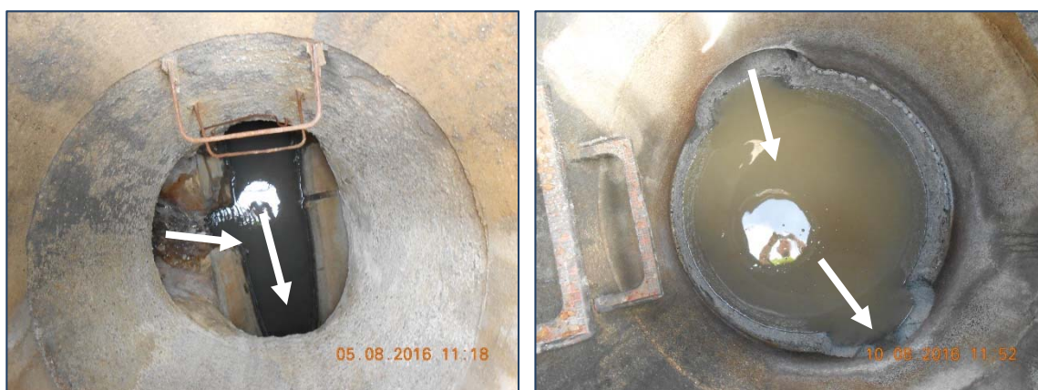
Figura 29: Exemples de pous de registre de la xarxa de sanejament en alta (sota titularitat de l'ACA), en la que es poden apreciar les dimensions del col·lector (DN 500 mm). (Esquerra) Pou p116 de l'inventari (sector PCE, marge dreta del riu Anoia); (dreta) Pou p179 de l'inventari, a la carretera de La Rata. Font: elaboració pròpia.
