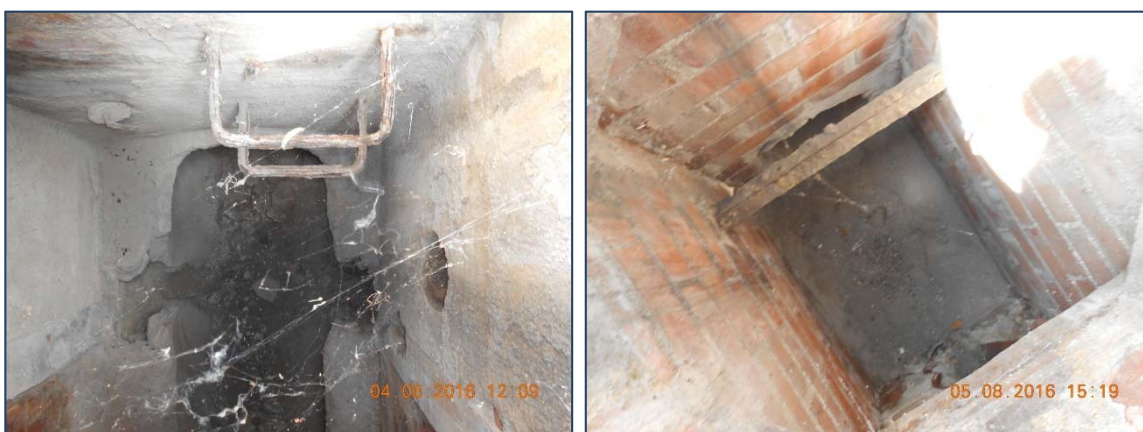
Figura 14: Exemples de trams de xarxa que correspondrien bé a antics traçats abandonats, bé a canalitzacions destinades exclusivament a drenatge pluvial: (esquerra) possiblement, el primer cas (pou p90 de l'inventari); (dreta) segon cas (pou p133 de l'inventari). Font: pròpia.
