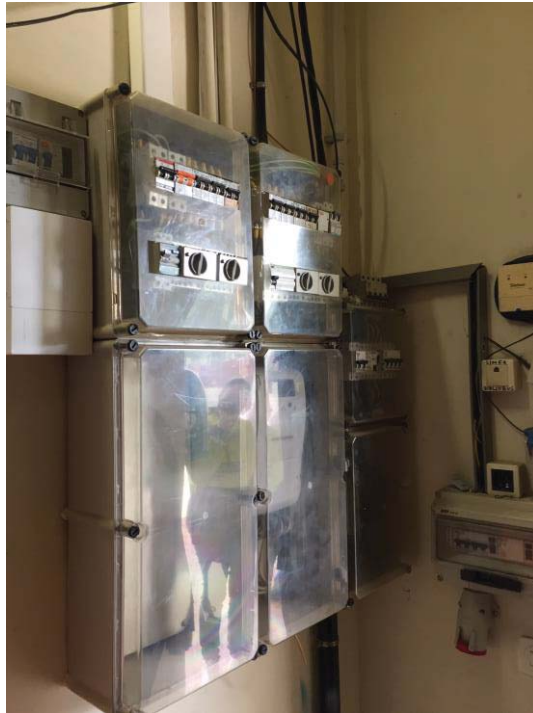
Imatge 3: Comptador i quadre elèctric general
