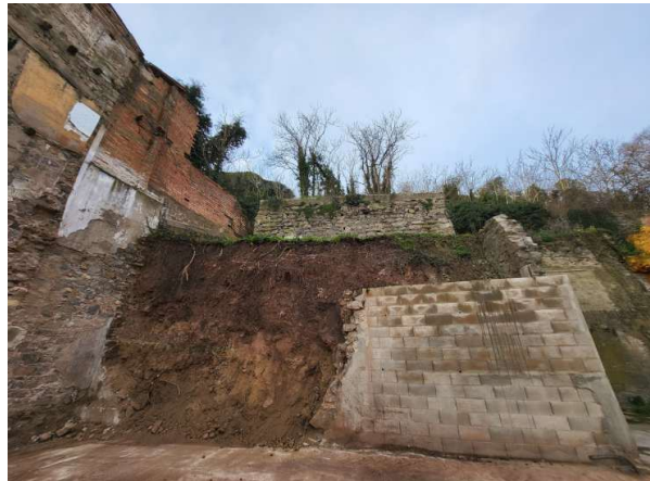
Talús posterior de la parcel·la, posteriorment a l'esllavissada i enderroc del mur
