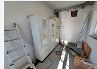
Quadres elèctrics nou motor
