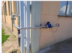
Caudalímetre i control de càrregues aigua regenerada
