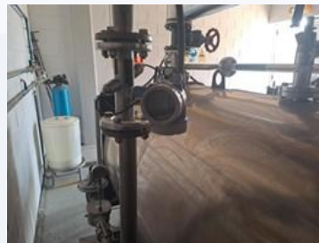
Caudalímetre biogas caldera
