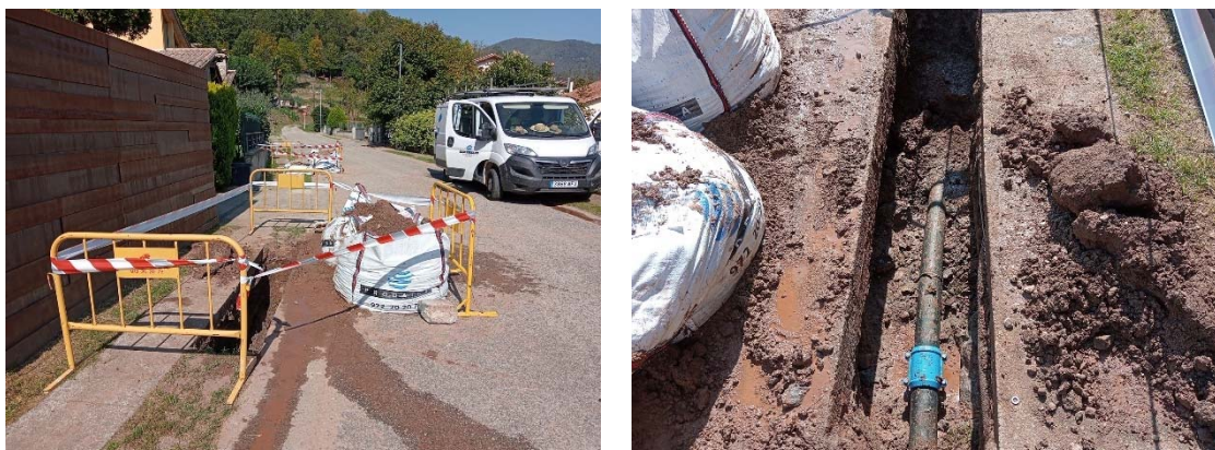
Fotografies de l'avaria reparada al Carrer Melcior Domenge de St. Privat d'en Bas que es va reparar
