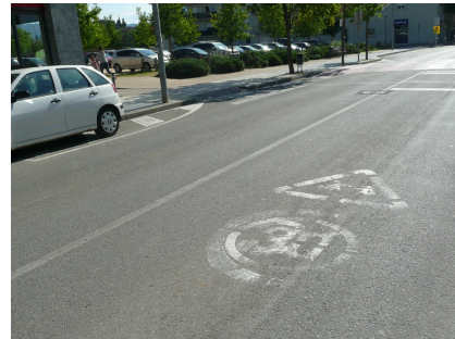
Imatge 34. Marques viàries que cal repintar.
