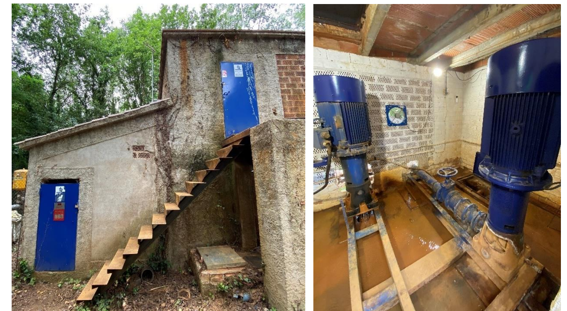
Figura 44 - EBAR Riera de Santa Coloma.
