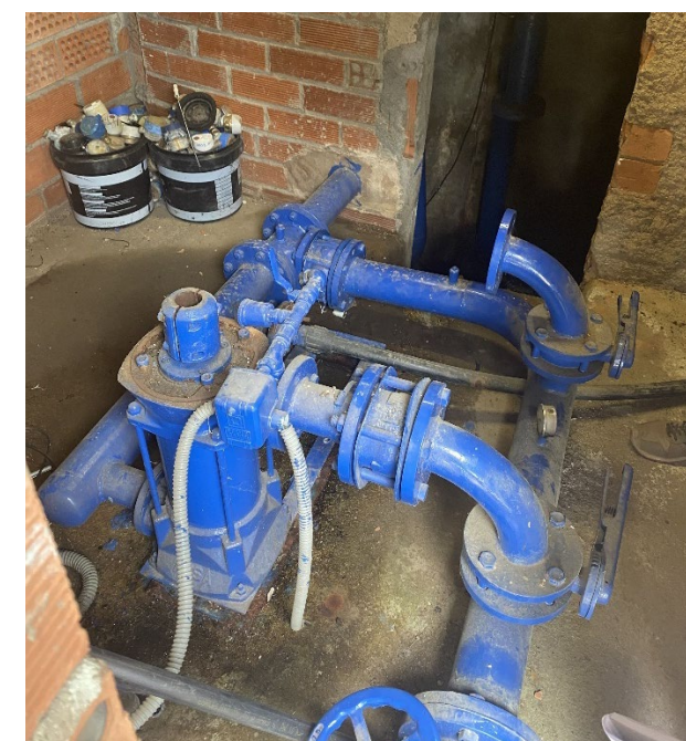
Figura 65. Dipòsit Can Villa.
