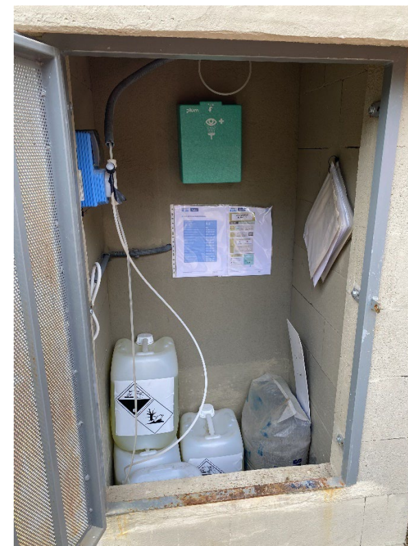
Figura 46. Sistema cloració Dipòsit Roure Vell.
