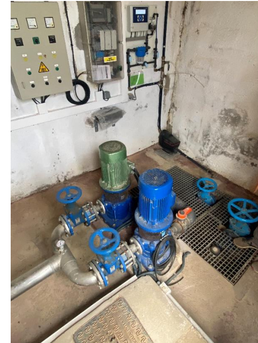
Figura 22 - Impulsió al Dipòsit St. Felip en el Dipòsit Santa Marta.
