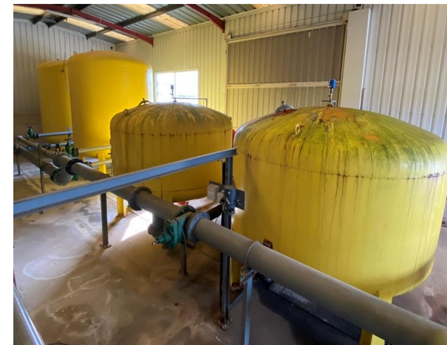
Figura 11 - Filtres de sorra i carbó actiu de l'ETAP.
