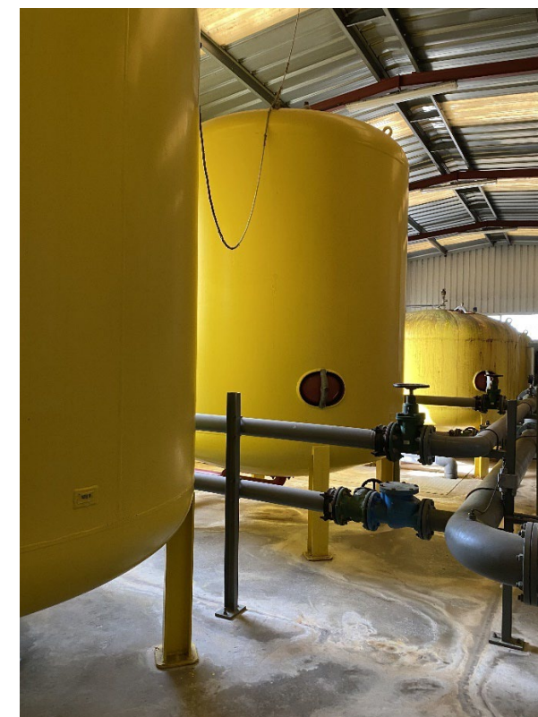
Figura 30. ETAP i Dipòsit Intermig.
