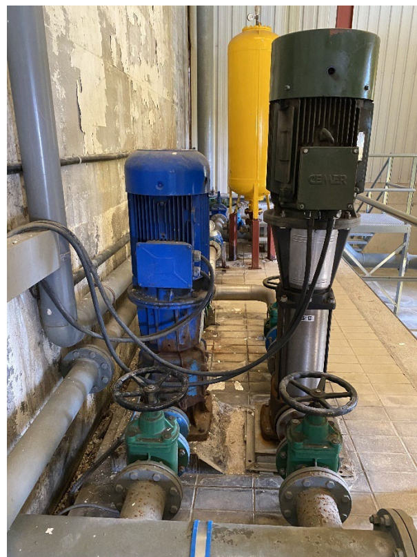
Figura 31. Bombes del Dipòsit Intermig.
