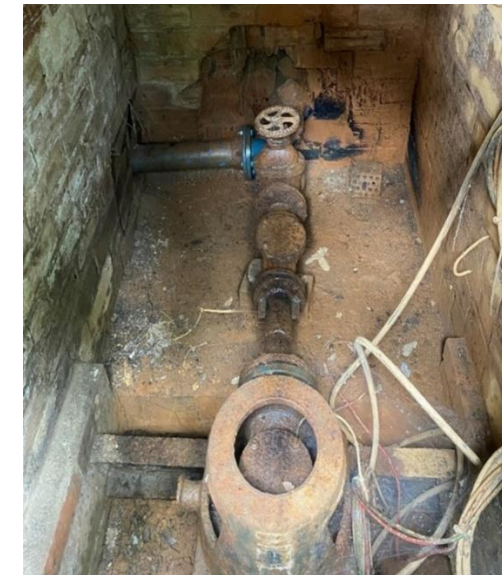
Figura 69 – Valvuleria del Pou Riera Santa Coloma B.
