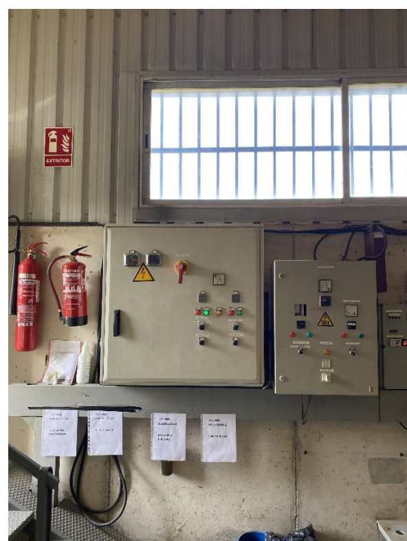
Figura 32. ETAP i Dipòsit Intermig.
