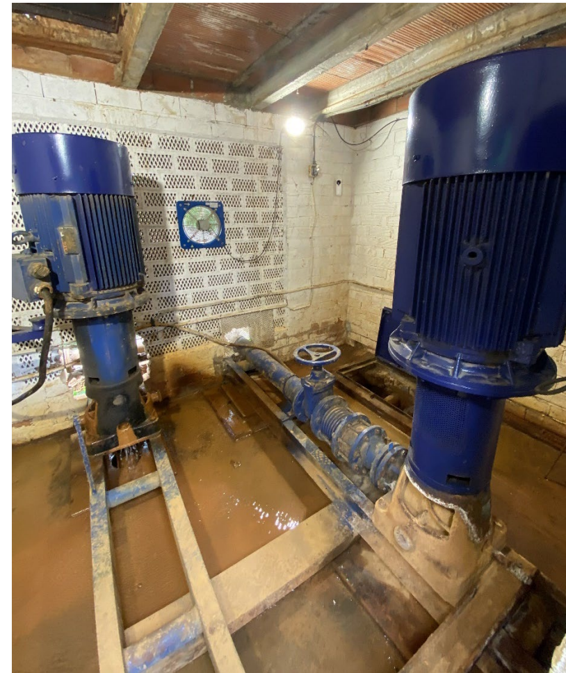
Figura 75. Estació de bombament Riera de Santa Coloma.
