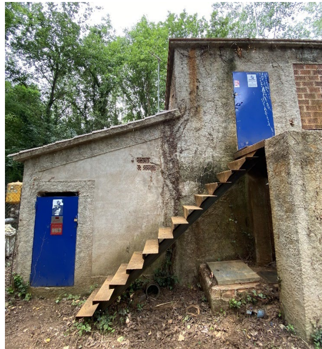
Figura 73. Estació de bombament Riera de Santa Coloma.
