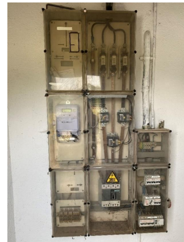
Figura 4 - Quadres elèctrics Pou Tordera.
