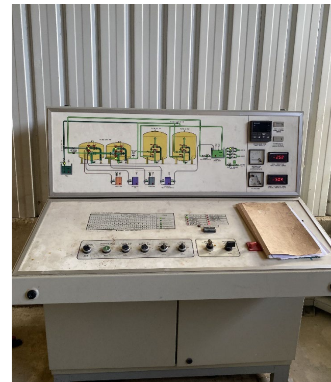
Figura 33. ETAP i Dipòsit Intermig.
