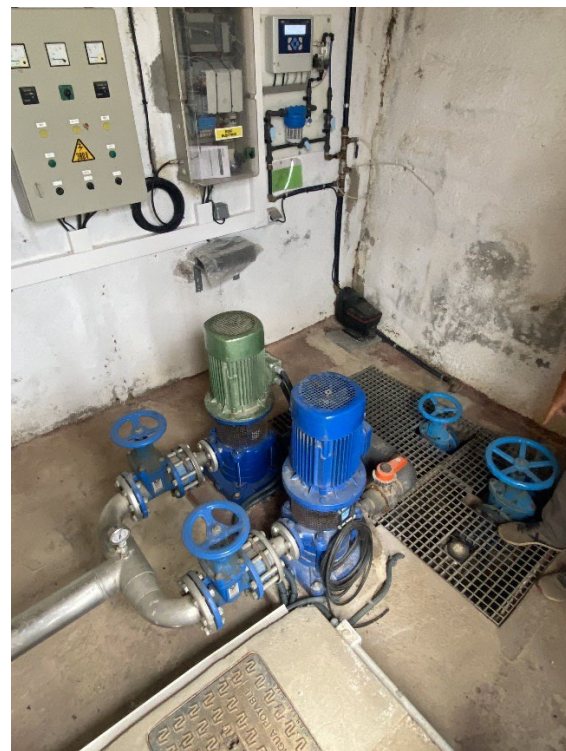
Figura 52. Bombament Dipòsit Santa Marta.
