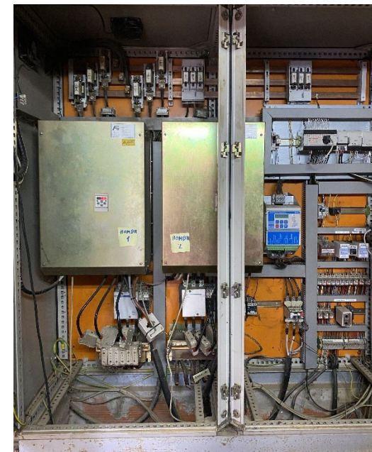
Figura 76. Quadres elèctrics Estació de bombament Riera de Santa Coloma.
