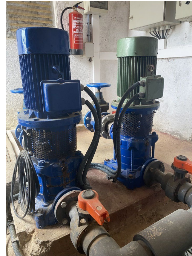
Figura 53. Bombament Dipòsit Santa Marta.
