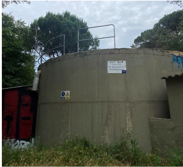
Figura 20 - Dipòsit Receptor i Estació Elevació Zona Esportiva.
