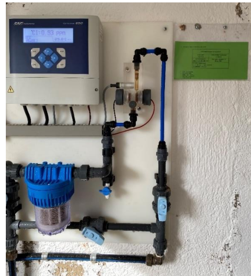
Figura 12 - Sistema de cloració.
