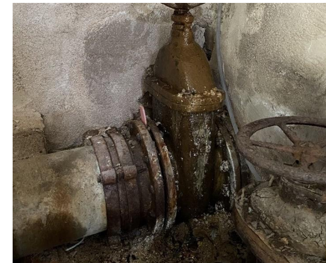
Figura 64 - Valvuleria dels Dipòsits de Puigtió en mal estat.
