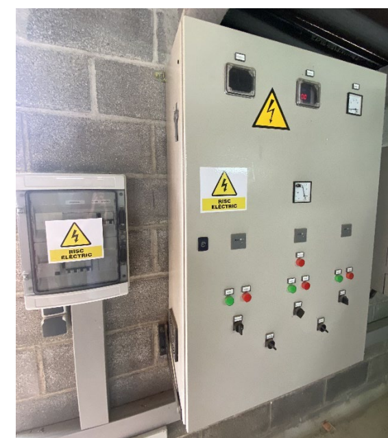
Figura 72. Estació acceleradora Can Picó.
