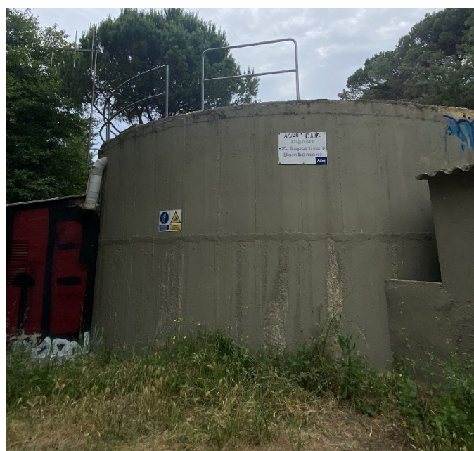
Figura 47. Dipòsit Receptor i Estació Elevació Zona Esportiva.
