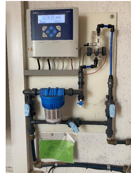
Figura 23 - Sistema de cloració.
