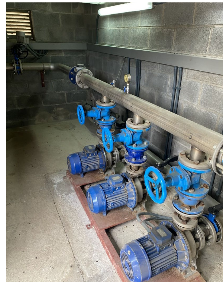
Figura 71. Bombes estació acceleradora Can Picó.
