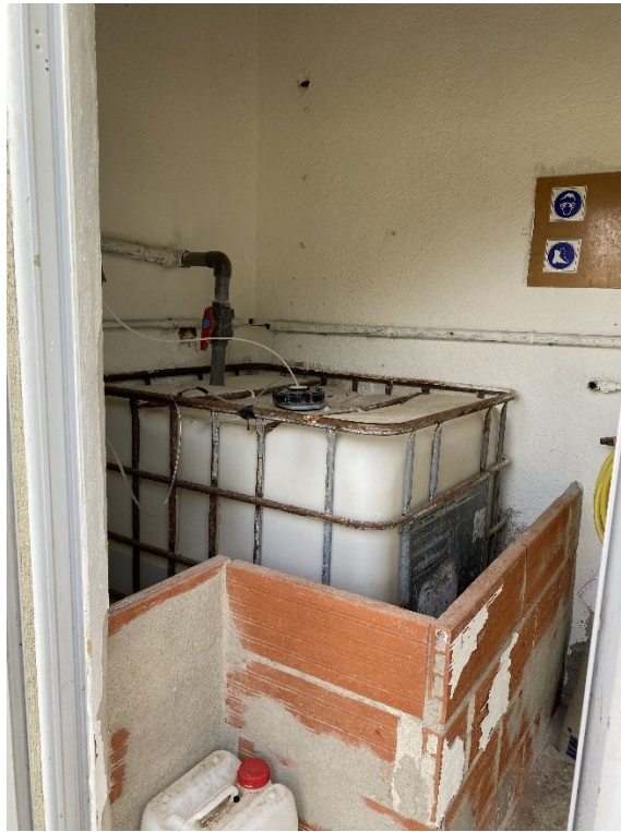
Figura 4. Sistema cloració Pou Tordera.
