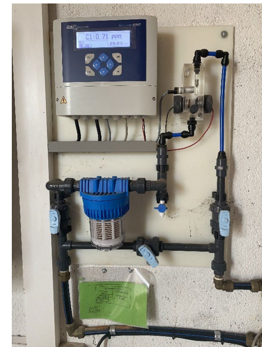
Figura 54. Sistema cloració Dipòsit Santa Marta.
