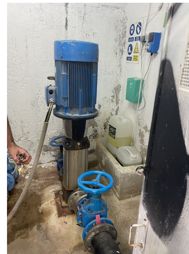
Figura 49. Dipòsit Receptor i Estació Elevació Zona Esportiva.
