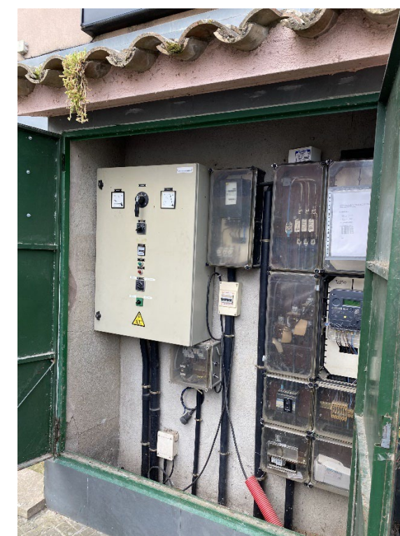
Figura 11. Quadres elèctrics Pou Ajuntament.
