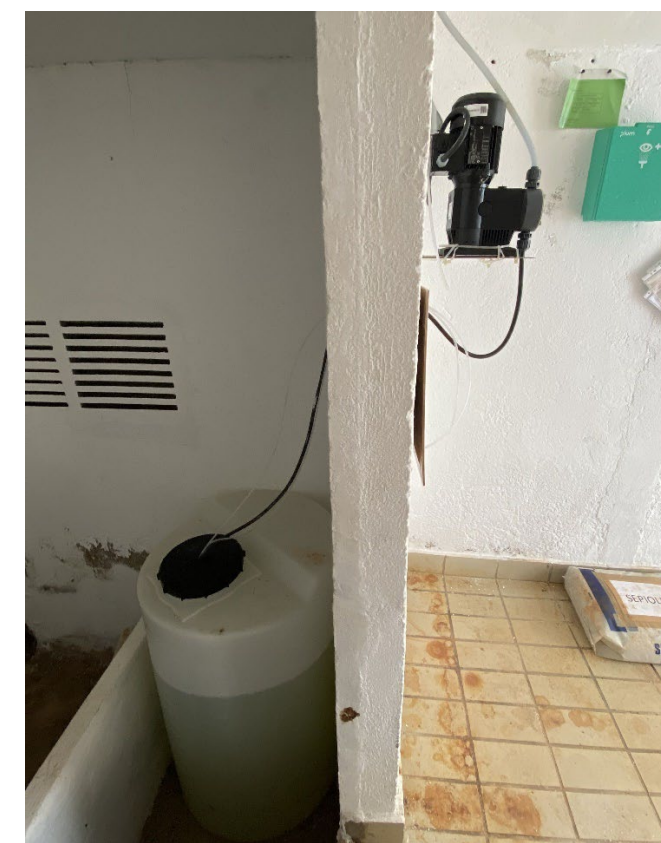
Figura 34. Sistema de cloració.
