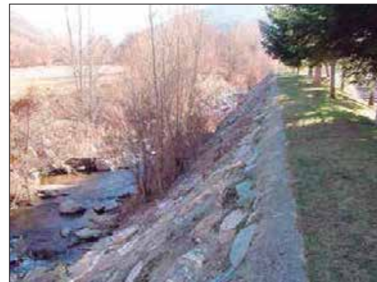
Foto 3. Protecció amb mota i escullera formigonada del marge esquerre del riu d'Alp.
