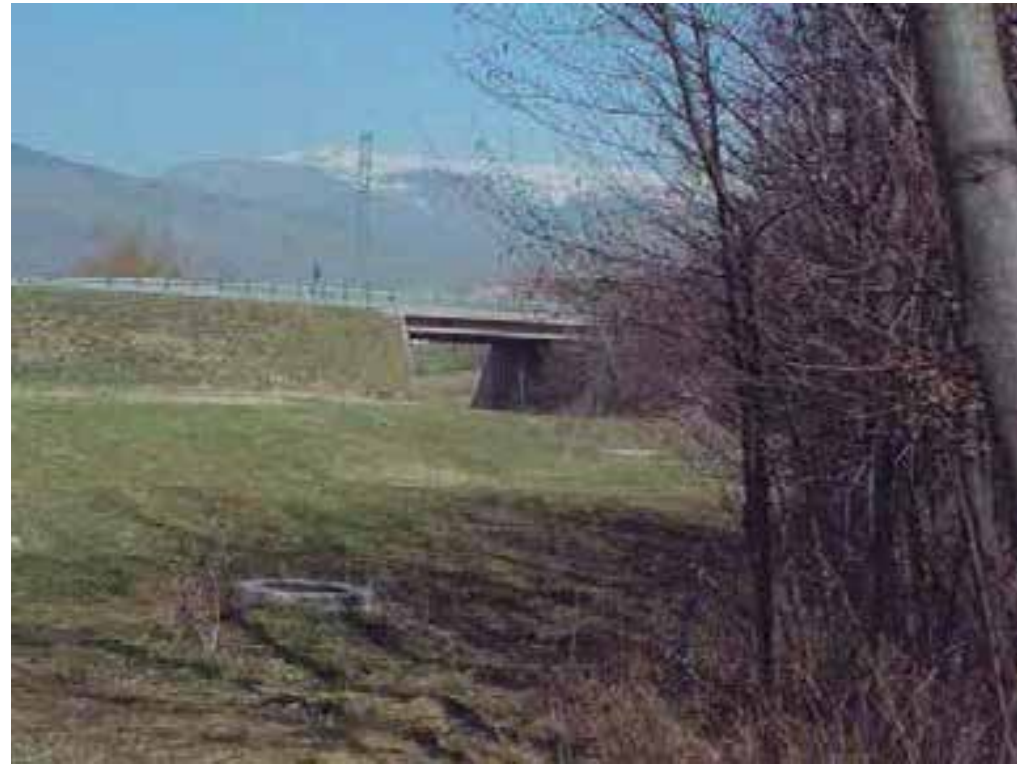
Fotografía núm. 1 : Vista aguas arriba del puente de la carretera C-16 sobre el río de Alp.
