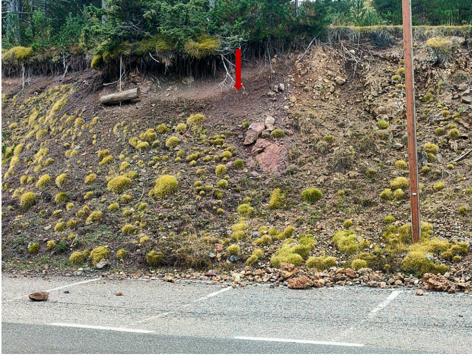
Fotografia 9: Esllavissades recents en un talús de l'aparcament de vehicles del l'avinguda de la Tossa d'Alp. S'observa una superfície de lliscament en sòls, amb dipòsits al peu formats per sorres, i blocs caiguts del dipòsit periglacial de fins a alguns centímetres de diàmetre.
