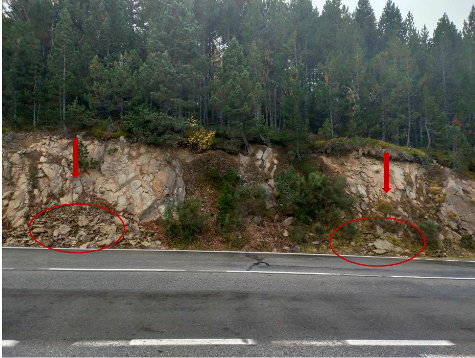
Fotografia 8: Esllavissades recents en un talús de l'avinguda de la Molina. S'hi observen superfícies de lliscament planar i en tascó, a favor del talús i dipòsits al peu formats per sorres i blocs de gresos.
