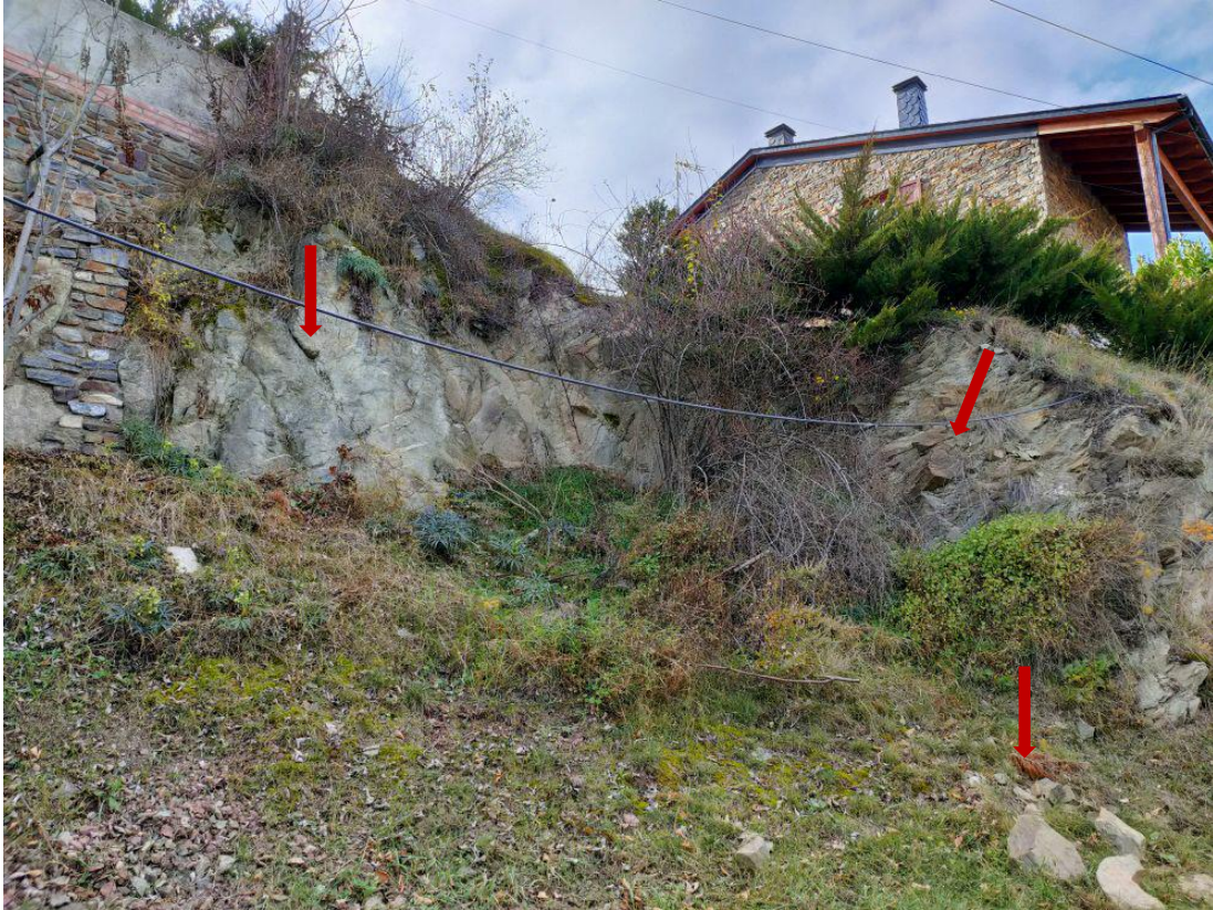
Fotografia 7: Petits esllavissaments en roca i caiguda de blocs recents en un talús i zona d'excavació per urbanització en l'avinguda de la Molina..
