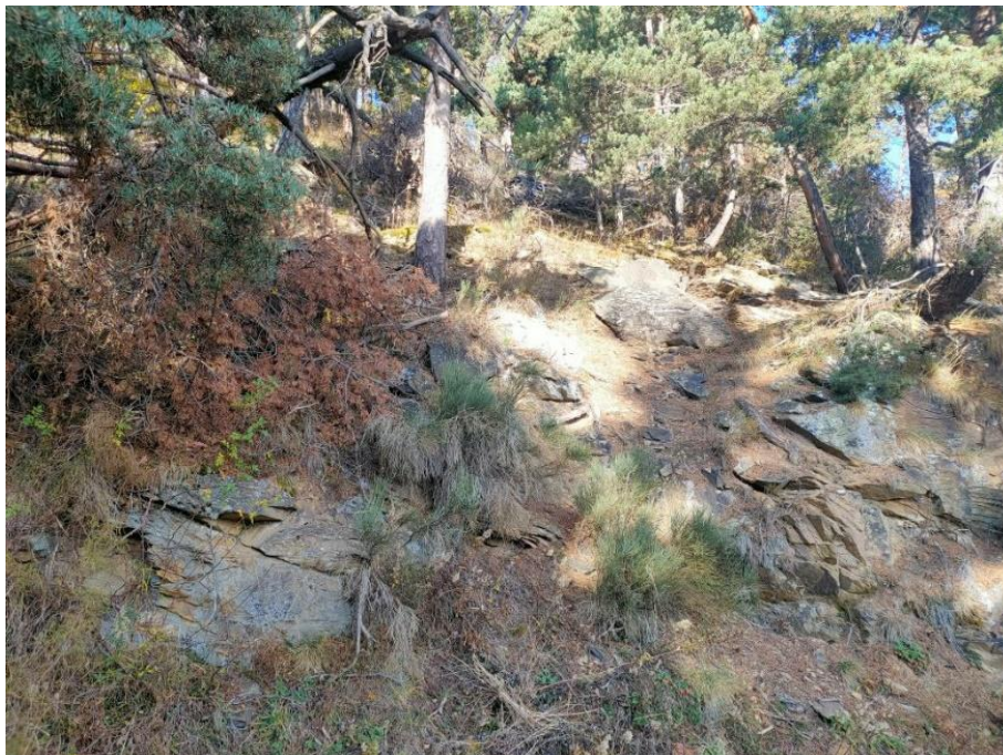
Fotografia 21: Caiguda de blocs recent en un talús del carrer Font de Recons
