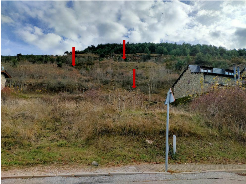
Fotografia 6: Petits esllavissaments en sòls i caiguda de blocs recents en un talús del camí Vell de Das. Correspon a la zona de falla que limita la fossa de la Cerdanya. S'observa principalment petits lliscaments en sòls amb caiguda de blocs, amb dipòsits al peu formats per sorres i blocs.
