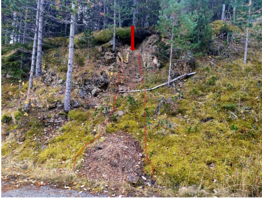
Fotografia 25: Esllavissada recent en un talús del l'avinguda de Masella. S'observa d'una banda una superfície de lliscament en roca, amb dipòsits al peu formats per sorres i blocs i, d'altra banda caiguda de blocs, de fins a alguns centímetres de diàmetre.
