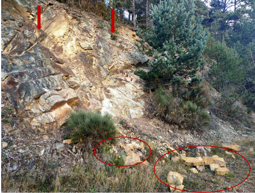
Fotografia 16: Despreniment recent en un talús en roca del carrer Puigmal. S'observen superfícies de lliscament planar i en tascó, a favor del talús i dipòsits al peu.
