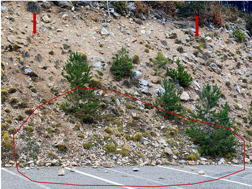
Fotografia 10: Petits lliscaments en sòl i caigudes recents de blocs en un talús d'una zona d'aparcament de vehicles del carrer Comaoriola, que formen dipòsits de sorres i blocs al peu que arriben fins a 1 metre del talús.
