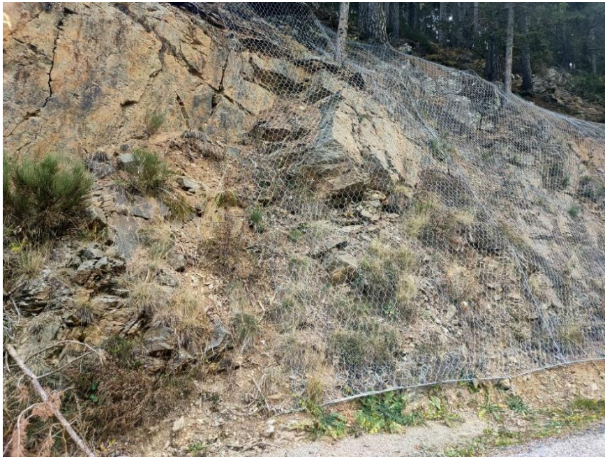
Fotografia 26: Esllavissades recents en un talús de desmunt al l'avinguda de Masella. S'observen superfícies de lliscament planar i en tascó, a favor del talús i dipòsits al peu formats per sorres i blocs de gresos. Sistemes de protecció i contenció que disminueixen el risc.
