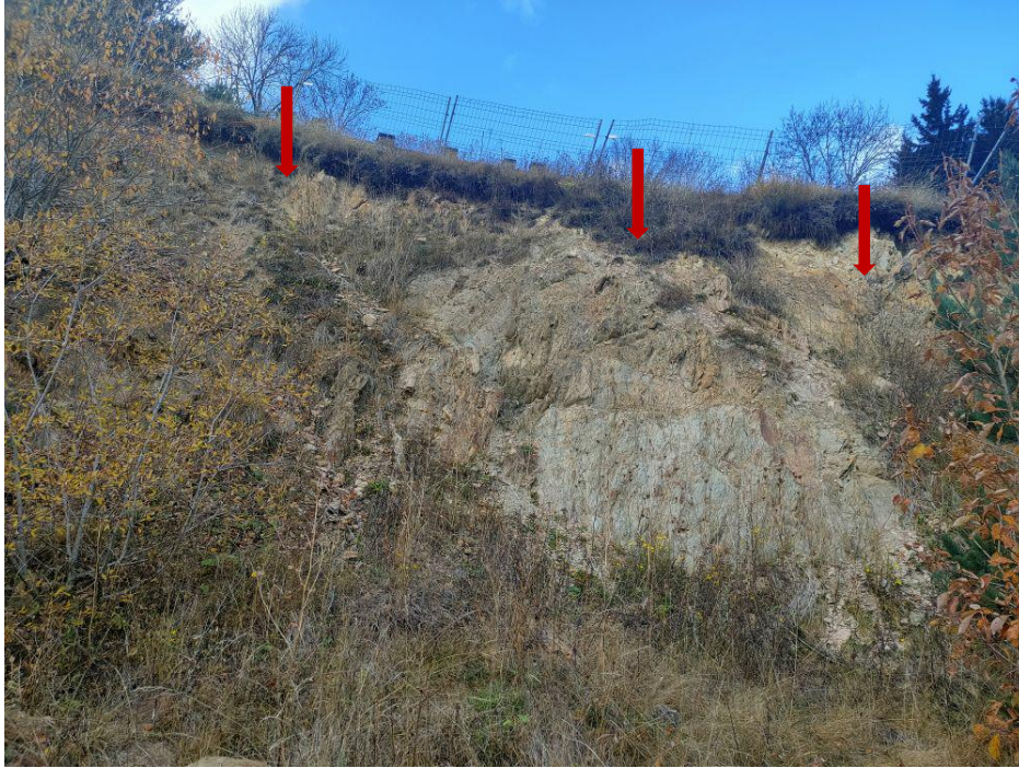
Fotografia 15: Esllavissada en un desmunt d'excavació per edificació, a l'avinguda d'Alp. S'observen una superfície de lliscament en roca, amb dipòsits al peu, i la caiguda de blocs, de fins a alguns centímetres de diàmetre.
