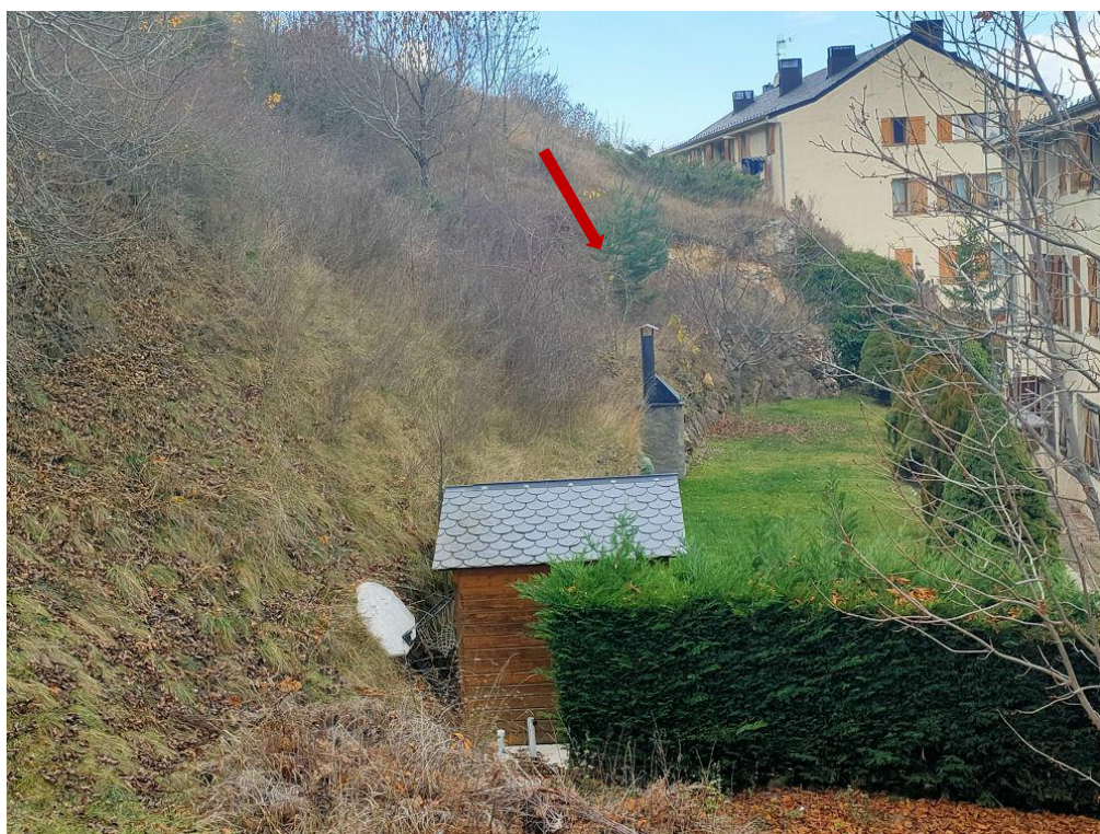
Fotografia 5: Talussos d'excavació i límit de patis posterior d'habitatges del carrer Cadí, amb mesures de contenció parcials, i susceptibles a lliscaments i caiguda de blocs.
