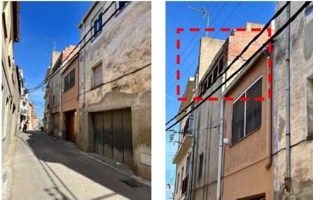
Imatges de l'estat actual d'aquesta mateixa façana on s'observa la part d'obertures de la planta segona NO prevista en projecte i el canvi d'alçada
