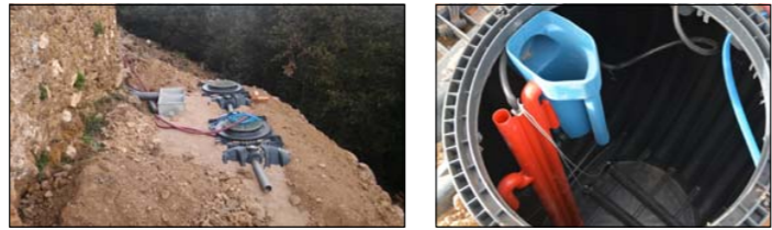
9. DEPURADORA BIOLÒGICA (Edifici de serveis) Capacitat de 13000l Capacitat de tractament en 24h: 2700l Sobrelevador
