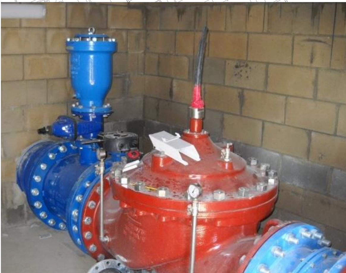
Vàlvula reguladora arqueta de Dragados
