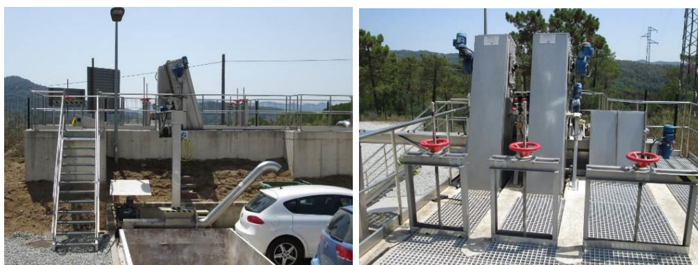
Pretractament de l'EDAR de Can Massuet – El Far. Detall de reixes de desbast, de fins automàtiques a l'esquerra, de gruixos manual a la dreta.
