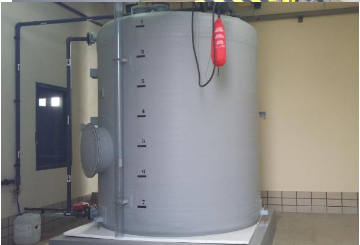
Dipòsits d'hipoclorit sòdic
