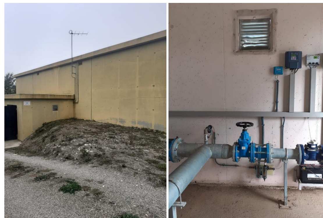
Imatge 4. Dipòsit Turó del Magre. Exterior. Interior sala de vàlvules
