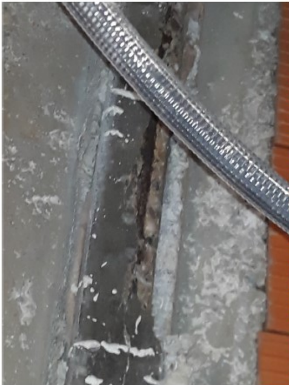
FOTO 1.- La part inferior de la biga està esquarterada. Es veu l'armadura
