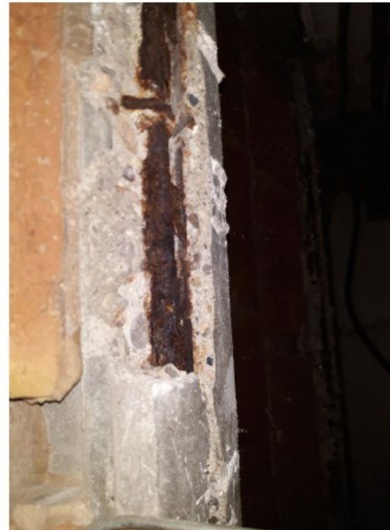
FOTO 7.- Armadura molt rovellada
