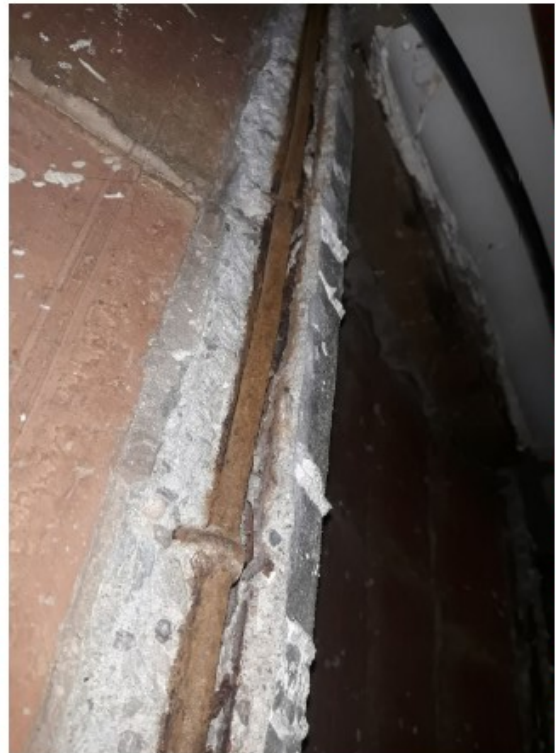
FOTO 3.- Falta de la part inferior de la bigueta totalment caiguda i l'armadura rovellada
