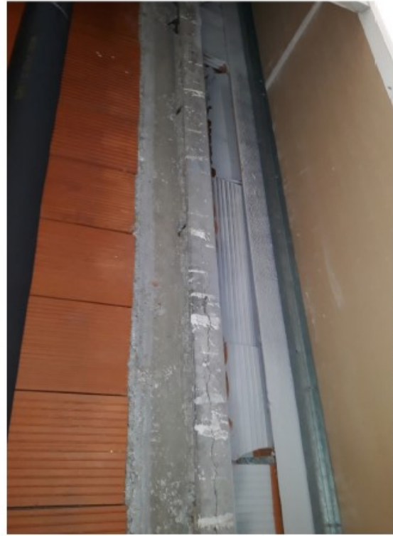
FOTO 8.- Biga amb fissura longitudinal
