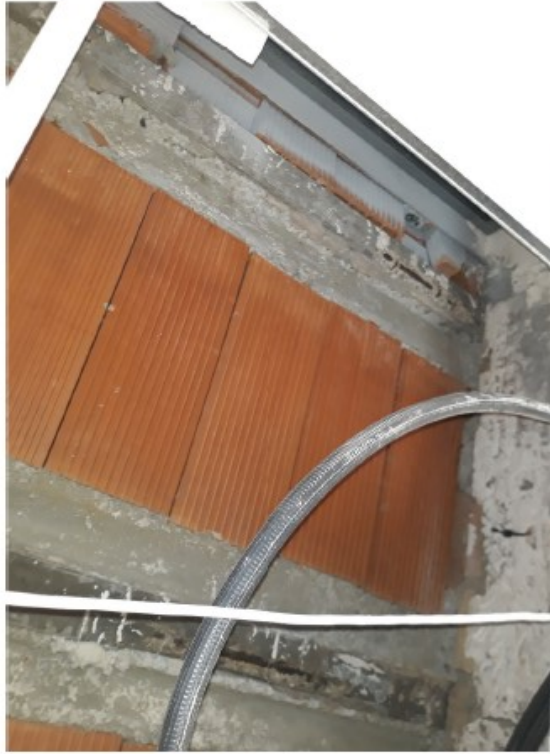
FOTO 6.- Esquerdes menors en biguetes però que deixen vista l'armadura
