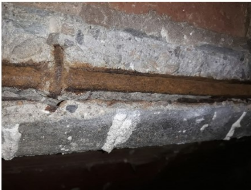
FOTO 8.- Armadura molt rovellada
