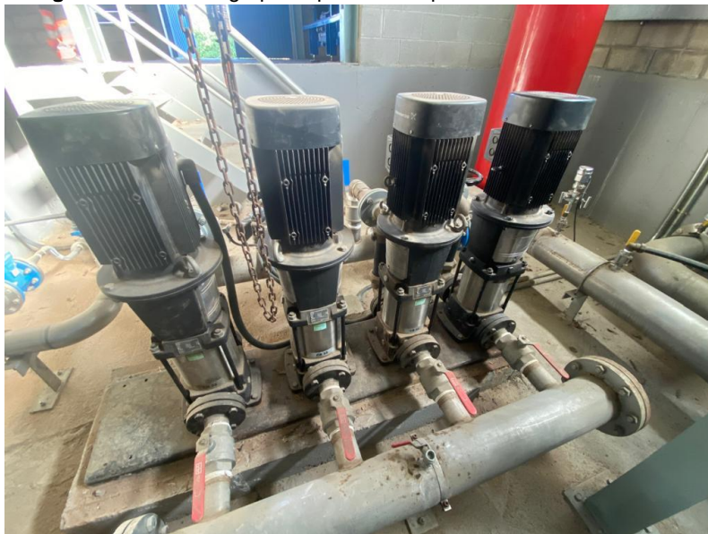
Fotografia 6. Vista del grup d'impulsió del dipòsit.
