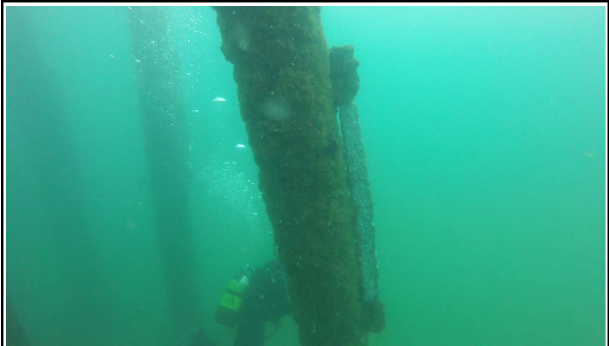
Imatge 23.- Ànode de sacrifici del pilot metàl·lic núm. 21B.
