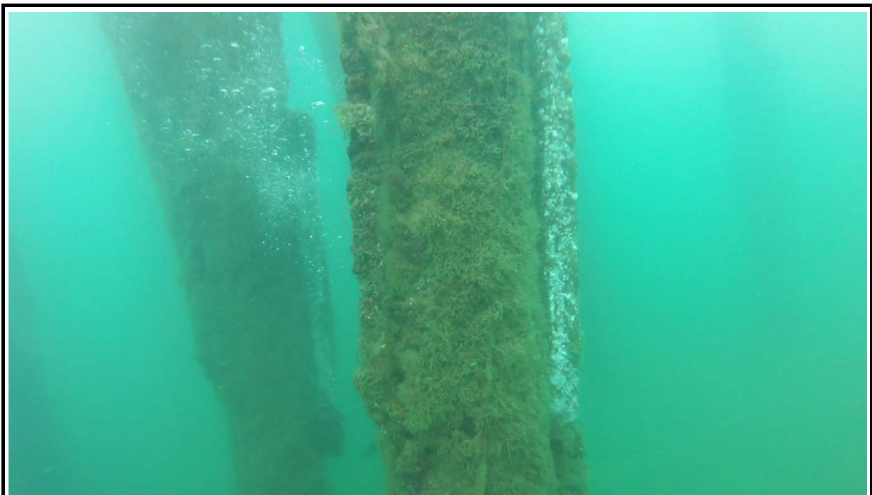
Imatge 24.- Ànode de sacrifici del pilot metàl·lic núm. 21M.
