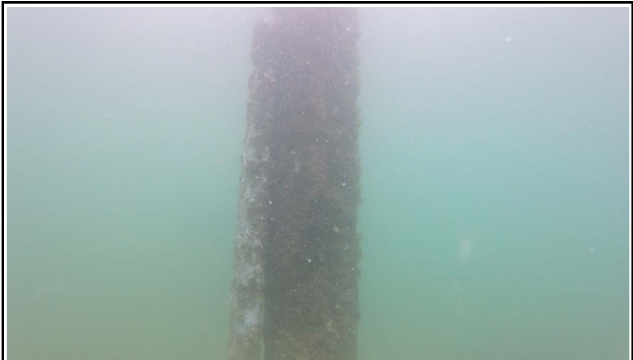
Imatge 43.- Ànode de sacrifici del pilot metàl·lic núm. 31B.
