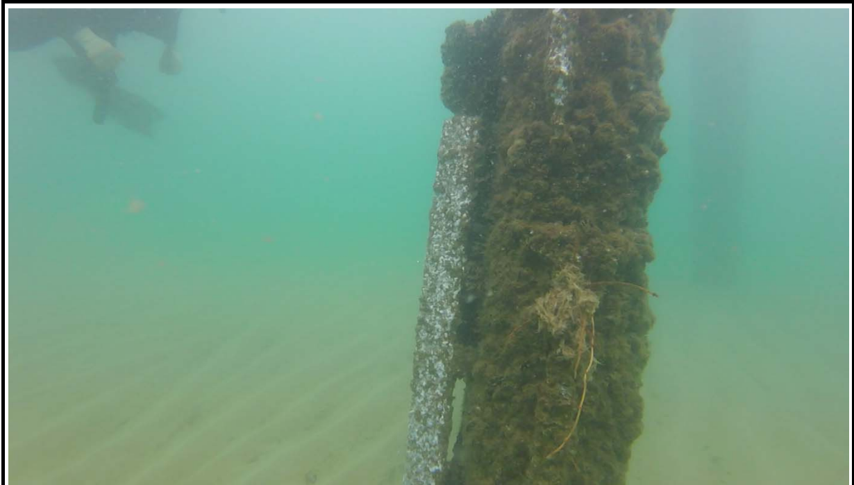
Imatge 35.- Ànode de sacrifici del pilot metàl·lic núm. 27B.
