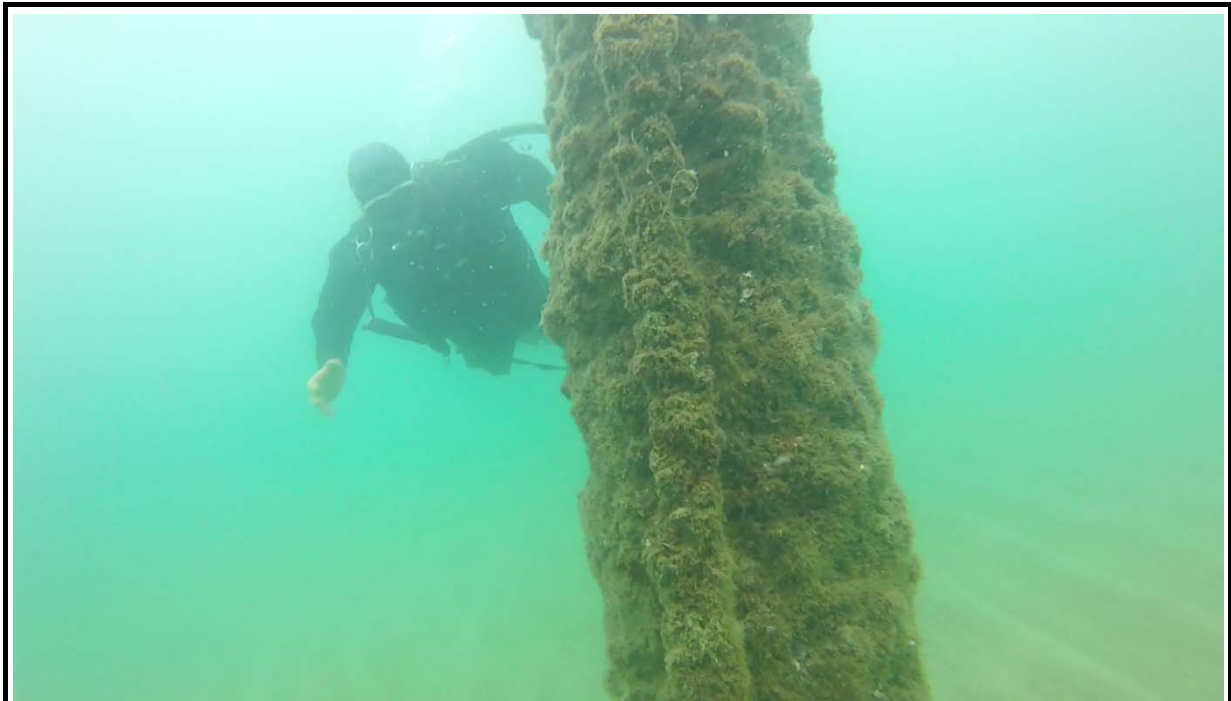
Imatge 27.- Pilot metàl·lic núm. 23B sense ànode de sacrifici.
