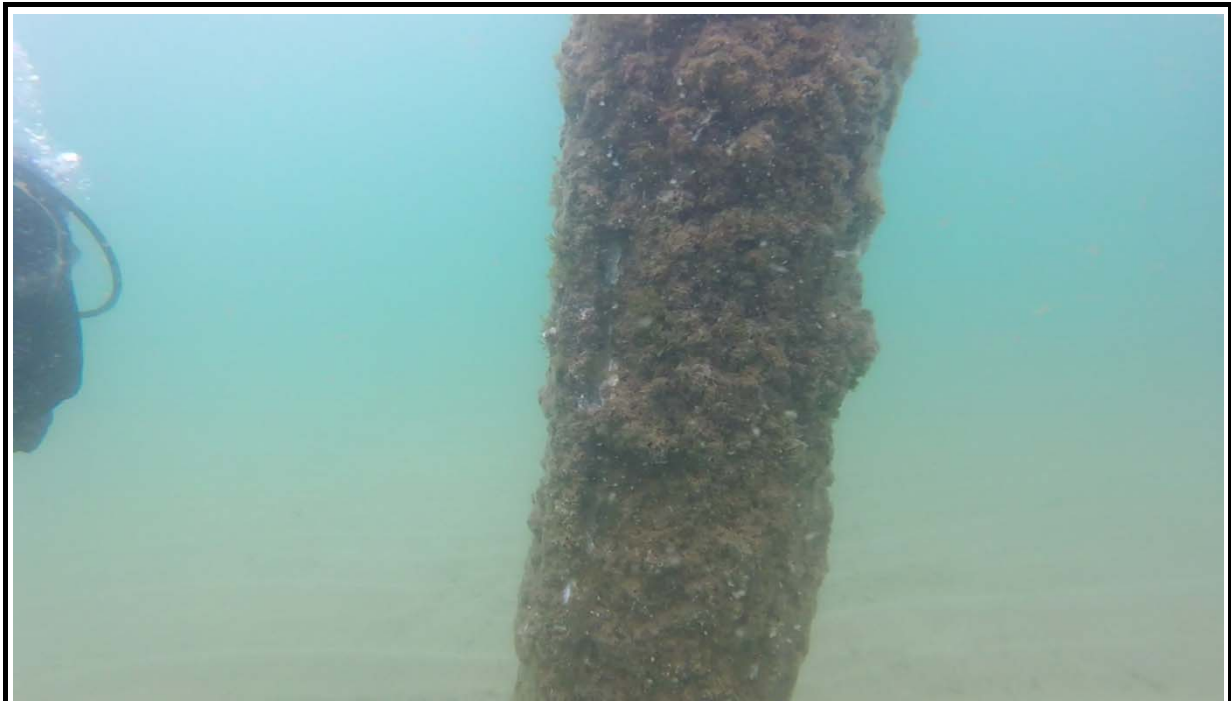
Imatge 41.- Pilot metàl·lic núm. 30B sense ànode de sacrifici.
