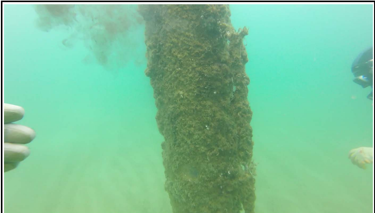
Imatge 31.- Pilot metàl·lic núm. 25B sense ànode de sacrifici.
