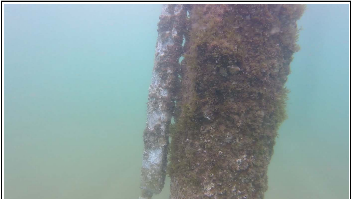
Imatge 49.- Ànode de sacrifici del pilot metàl·lic núm. 34B.
