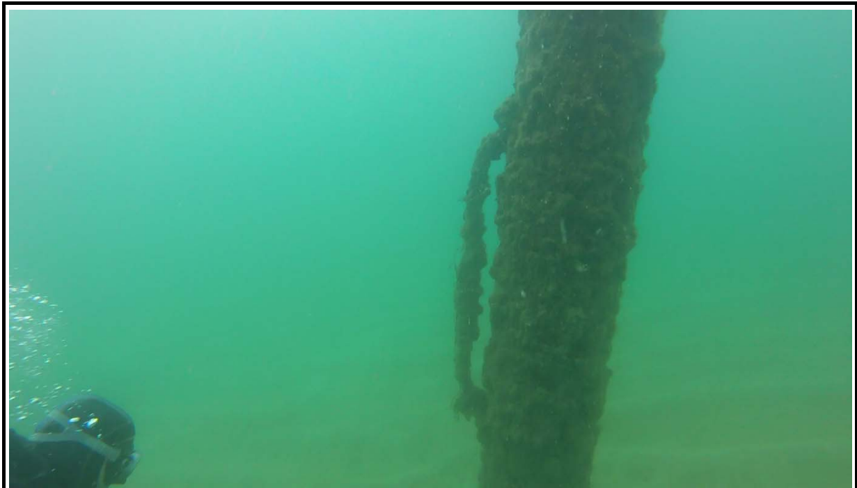
Imatge 29.- Pilot metàl·lic núm. 24B sense ànode de sacrifici.
