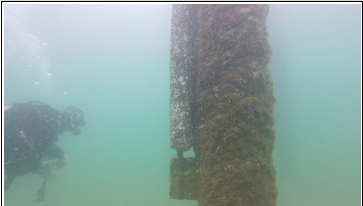
Imatge 47.- Ànode de sacrifici del pilot metàl·lic núm. 33B.
