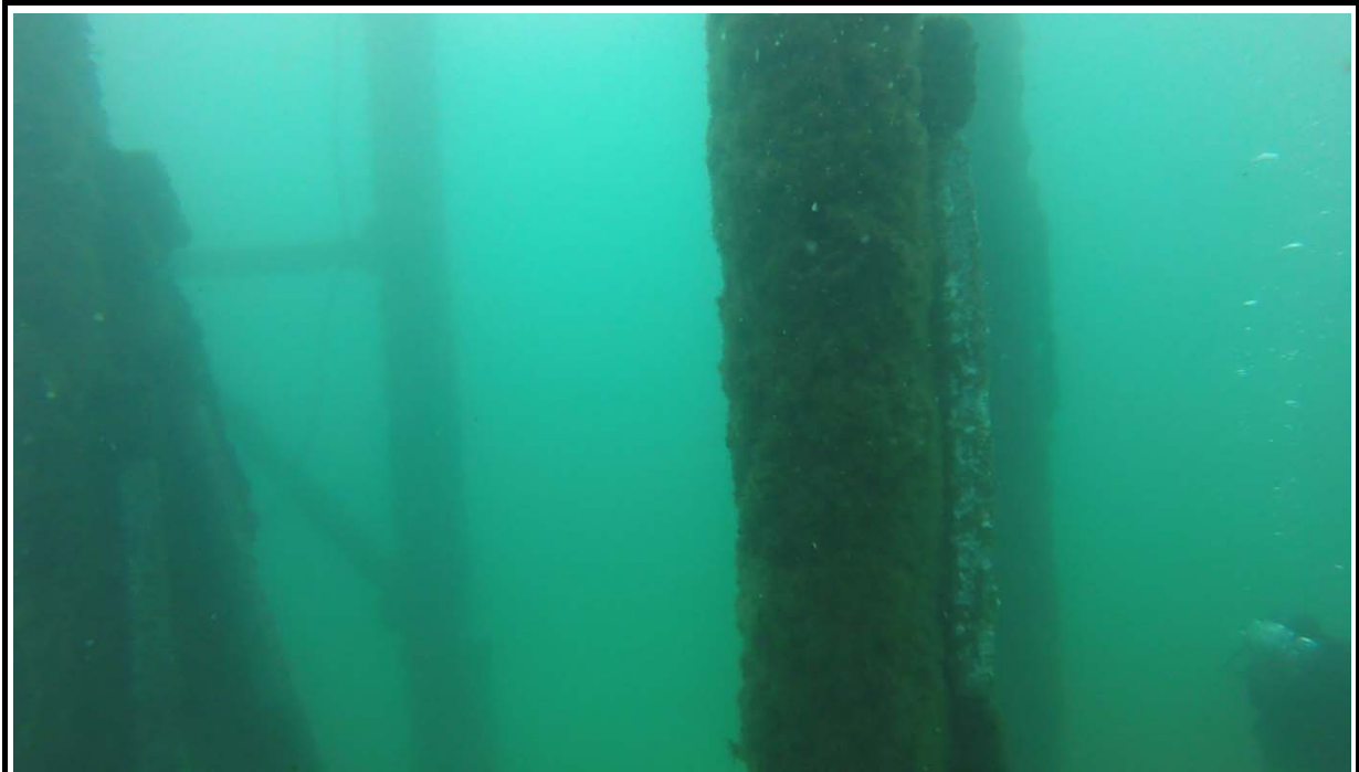
Imatge 17.- Ànode de sacrifici del pilot metàl·lic núm. 13.
