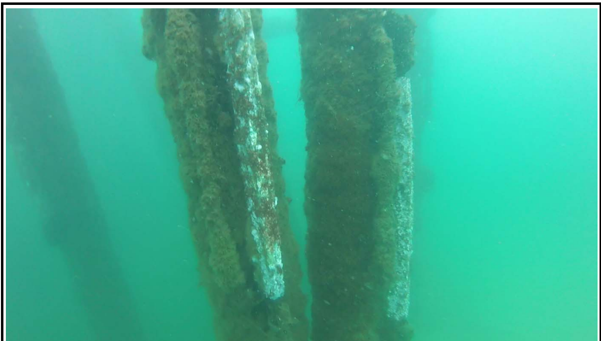
Imatge 18.- Ànodes de sacrifici dels pilots metàl·lics núm. 8 (dreta) i núm. 14 (esquerre).
