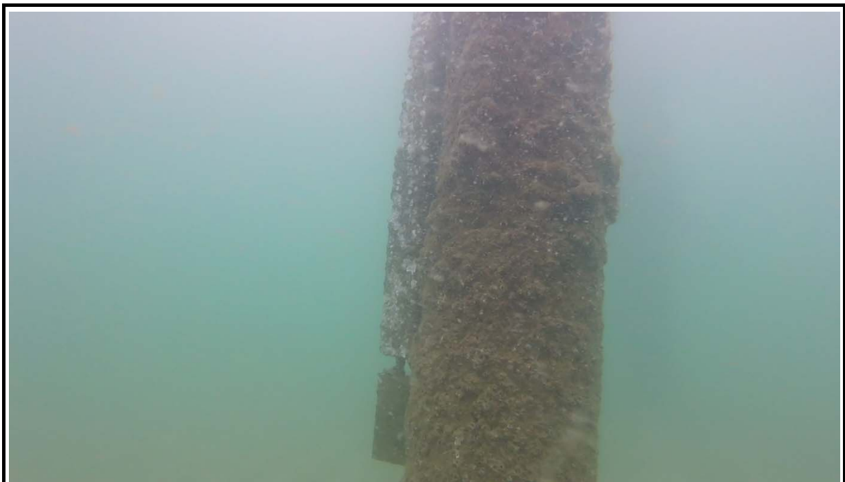
Imatge 48.- Ànode de sacrifici del pilot metàl·lic núm. 33M.
