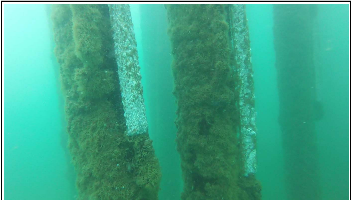
Imatge 13.- Ànodes de sacrifici dels pilots metàl·lics núm. 9 (dreta) i núm. 7 (esquerra).
