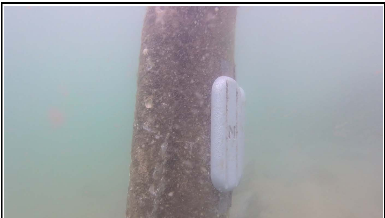
Imatge 52.- Ànode de sacrifici del pilot metàl·lic núm. 35M.
