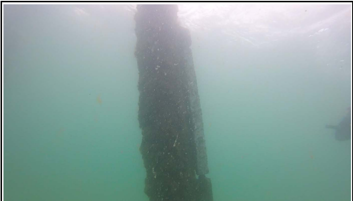
Imatge 46.- Ànode de sacrifici del pilot metàl·lic núm. 32M.
