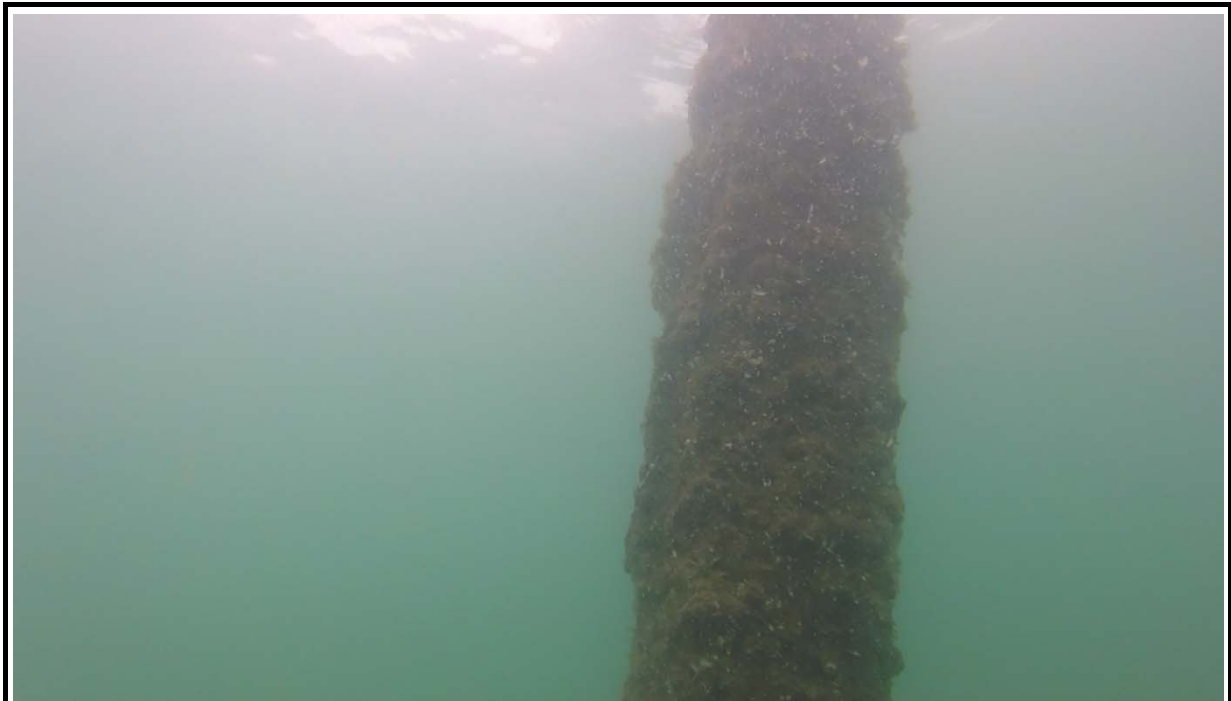
Imatge 39.- Pilot metàl·lic núm. 29B sense ànode de sacrifici.
