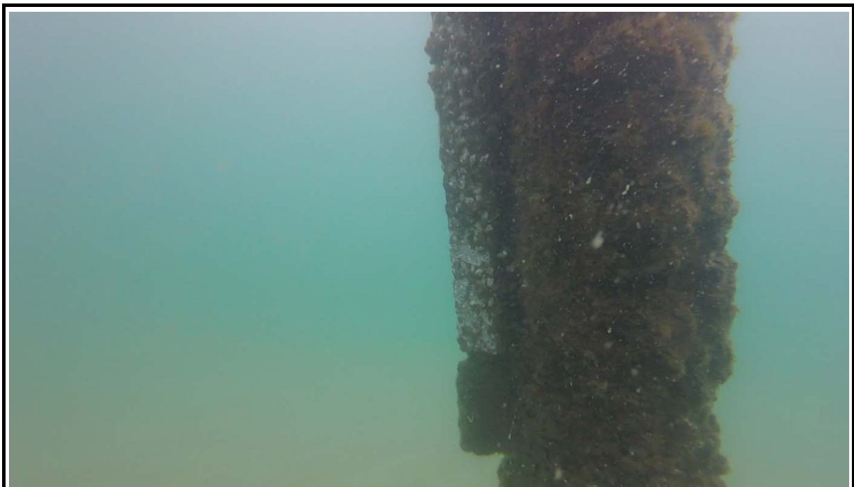
Imatge 40.- Ànode de sacrifici del pilot metàl·lic núm. 29M.
