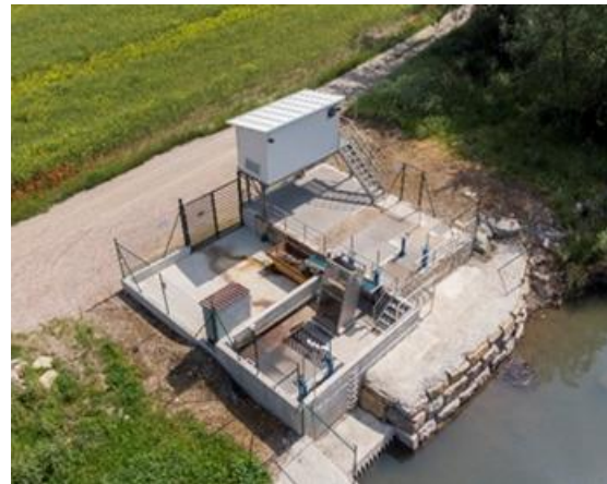
Foto 1 - Captació superficial OSONA SUD - Riu Ter
