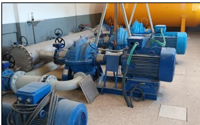
Figura 14. Vista general de la impulsió de Sant Marc.
