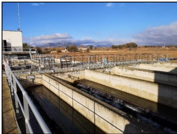
Foto 7 - Vista dels filtres de carbó actiu
