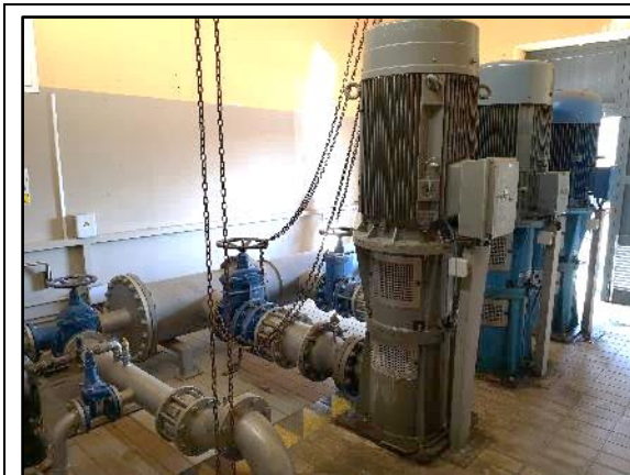
Figura 11. Bombes de la impulsió cap a Sant Marc.
