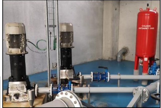
Foto 23 - Bombeig d'Orís i placa de la bomba.
