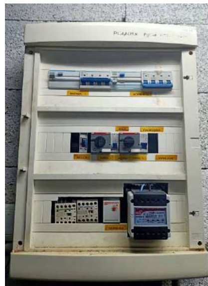
7.- S. Quadre filtració piscina
