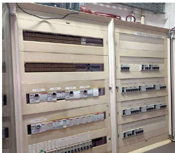
5.- S. Quadre Sala de Calderes
