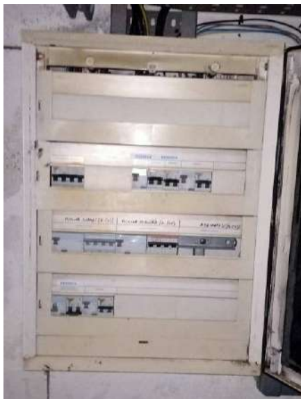
3.- S. Quadre Equip de Filtració
