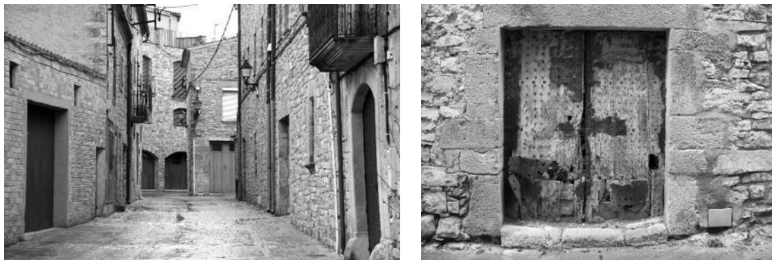
Figura 2-48: Imatge de l'estat de conservació del parc edificat de Passanant i Belltall.
