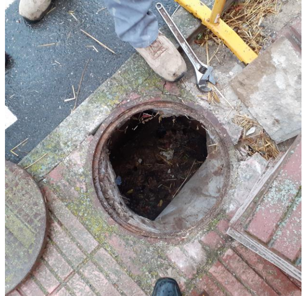
Foto 03.2 Pou existent al C-14. Connexió nou bombament.
