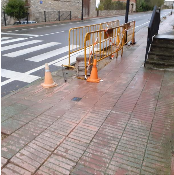
Foto 03.1 Pou existent al C-14. Connexió nou bombament.
