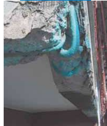
Hierros de armadura del frente de un balcón tratados con Mapefer 1K
