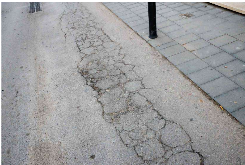
Desgast del paviment d'aglomerat asfàltic de la zona central del carrer, destinada al trànsit rodat, a l'alçada del carrer Sant Llop.
