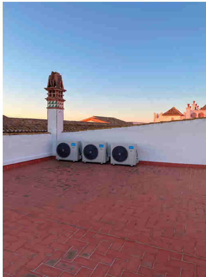
Màquines de climatització de la sala de reserva del Sarcòfag, una de les actuacions dutes a terme durant l'any 2023.
