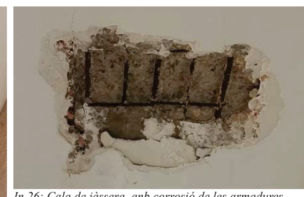
In 26: Cala de jàssera amb corrosió de les armadures.
