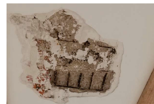
In 25: Cala de jàssera en la qual es verifica que hi ha corrosió de les armadures.
