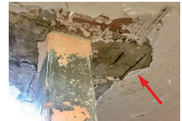
In 24: Armadures corroidas i amb corrosió en zona amb humitats.
