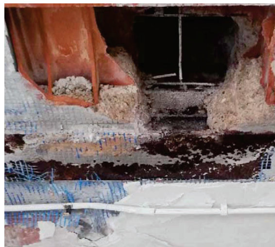
In 28: Cala realitzada. Es veu oxidació en tota la superfície, però sense perdues apreciables de secció
