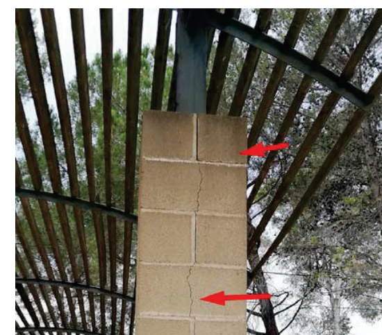
In 32: Exemple de pilar amb la fàbrica trencada.
