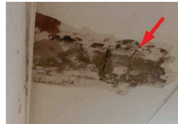
In 23: Armadures amb corrosió i recobriment escàs
