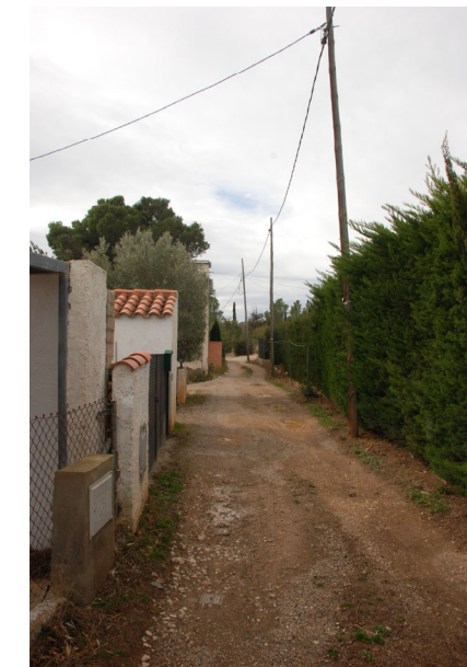
Fotografia de la xarxa elèctrica aèria
